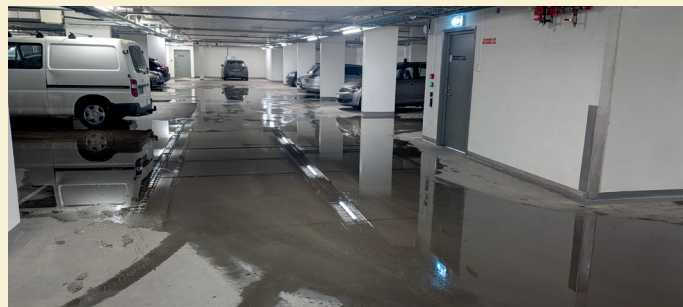
Manglende sluk i parkeringsanlegg kan medføre at vann blir liggende og forårsaker skader. Foto: SINTEF
