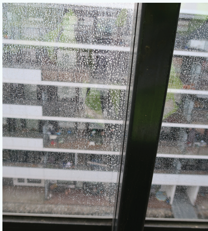
Balkongrekkverk med merker fra vann som har vært i kontakt med betong.
