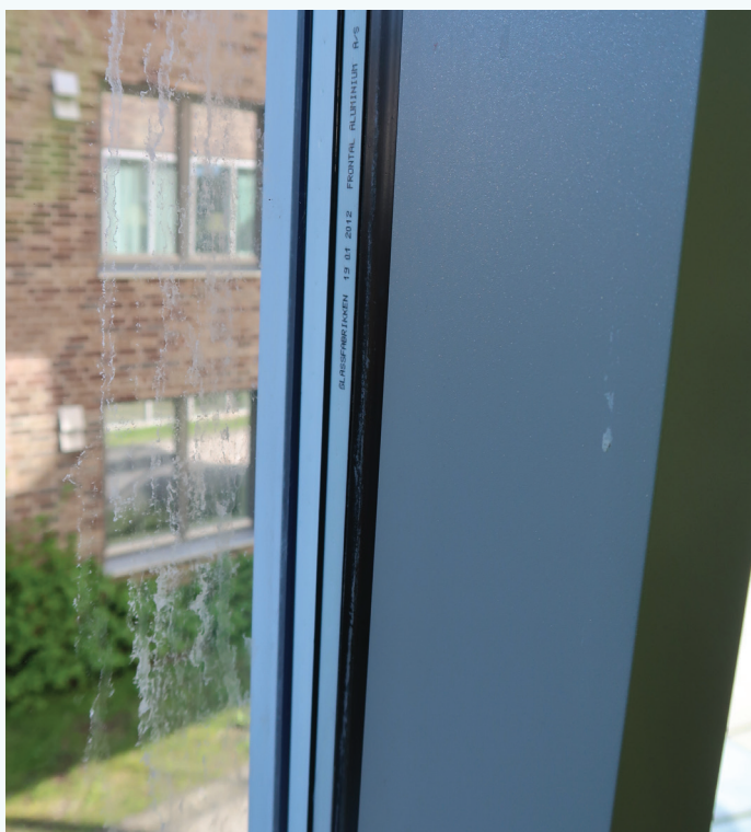
Glassfasade med etseskader. Over denne glassfasaden er det en kledning av teglforblending hvor vann som kommer bak kledningen, ikke ledes bort fra glasset.
