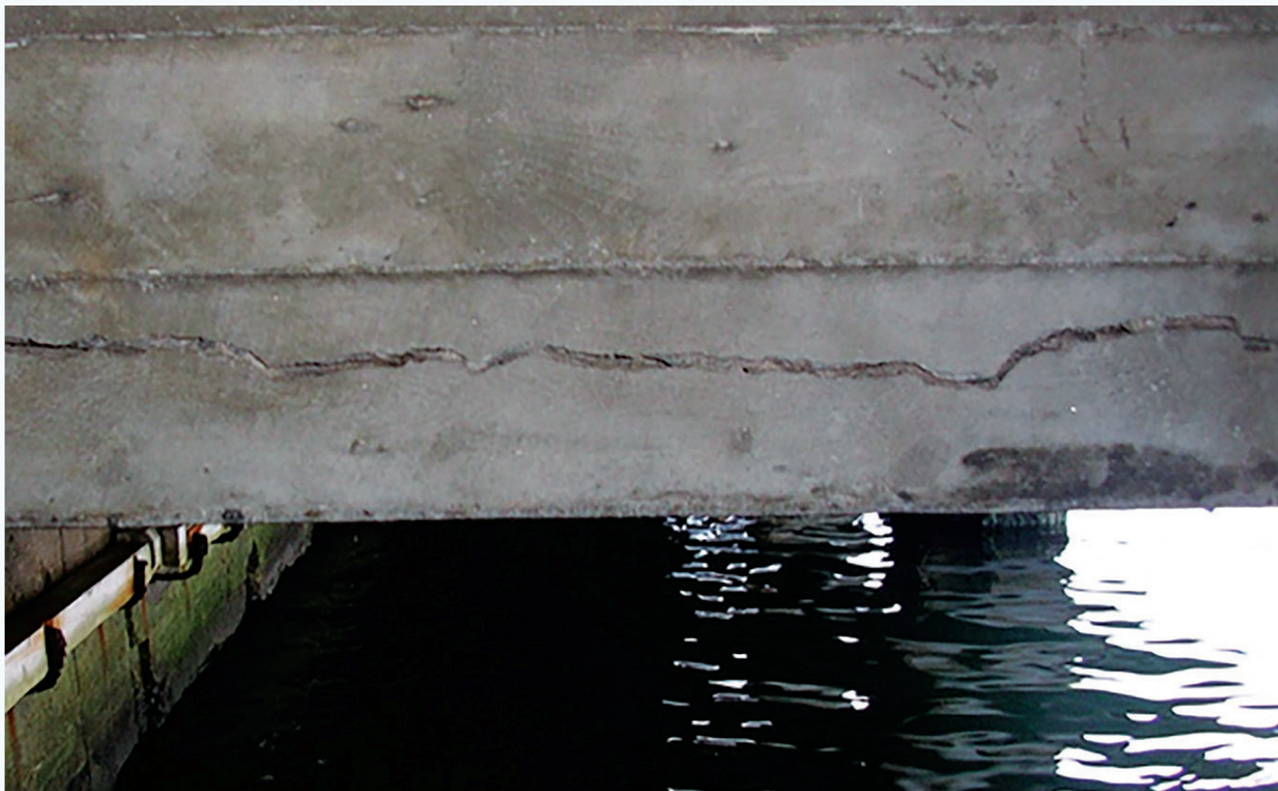
Bildet viser en kaidrager med sprekk langs underkant som et resultat av rustsprengning.
