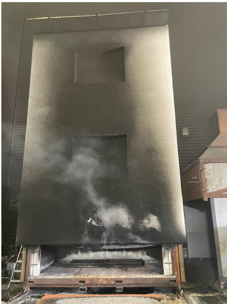
Figur 4 Skader på fasade med LIP pussystem etter gjennomført SP Fire 105 fasadetest. [Illustrasjon: Jackon AS]
