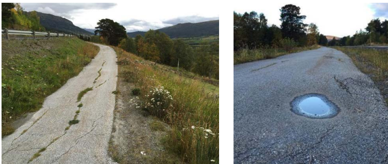
Figur 6 Eksempler på alvorlig skadeutvikling på gang- og sykkelveg langs E136 i Lesja kommune bygd etter forenklet standard. Kilde: Andersen (2016)
