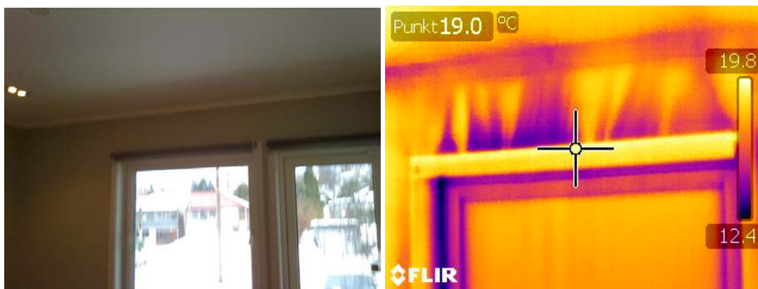
Figur 1 Lekkasje mellom nyinnsatte vinduer og veggen (stue).
