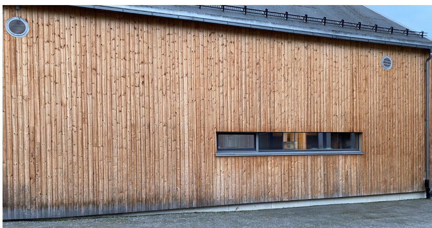
Figur 4.1 Nordfasaden på ZEB Test Cell Laboratory i Trondheim viser med stor tydelighet betydningen av å avslutte kledninger i størrelsesorden 0,3 m fra bakkenivå for å hindre oppfukting og nedsmussing av kledningen på grunn av snøakkumulasjon og vannsprut.
