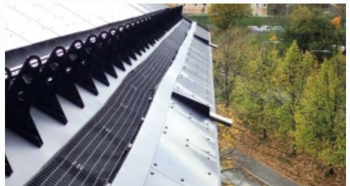
Takavslutning med «varm» takrenne, snøfangarar, løvsamlar og nødoverløy. Foto: Tore Kvande
