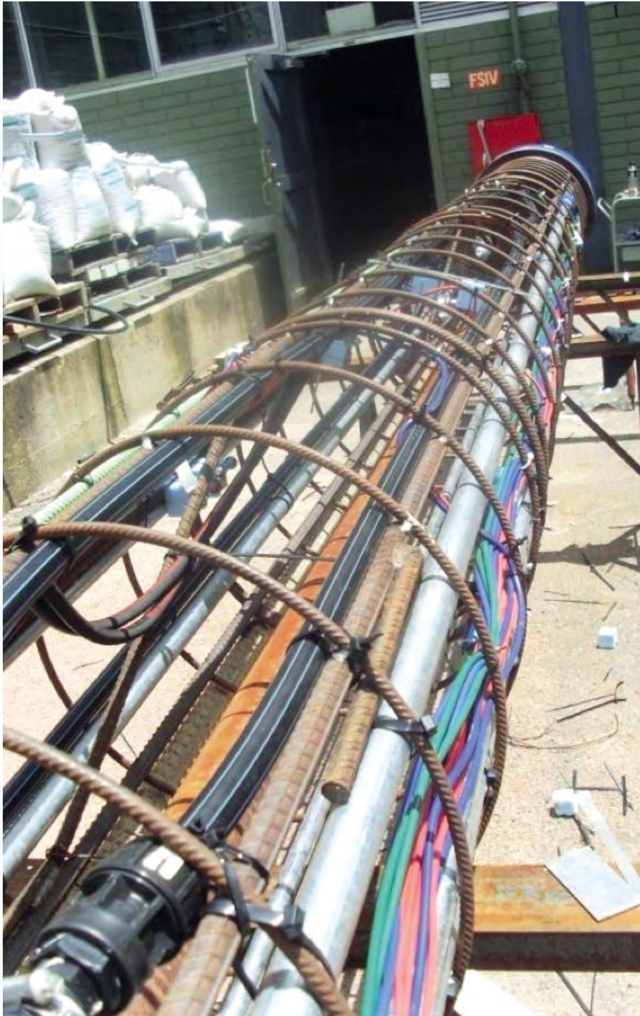
Armering til en feltskala energipel (20 m lang og 600 mm i diameter) med kollektorsløyfer og måleinstrumenter. Foto: Rao Martand Singh (NTNU).
