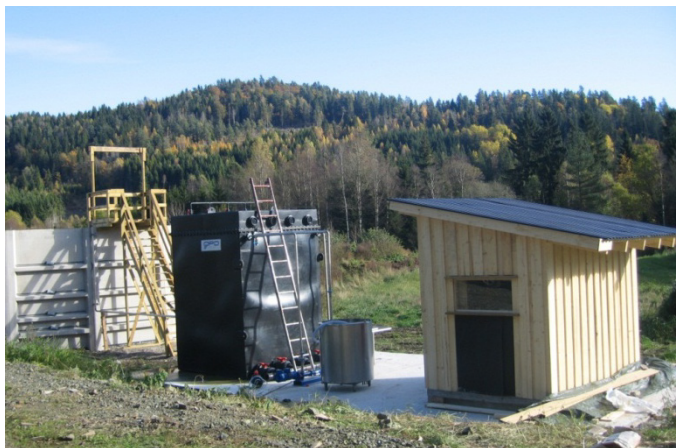
Figur 28 ABR Kompakt Biogassreaktor for flytende organisk avfall
