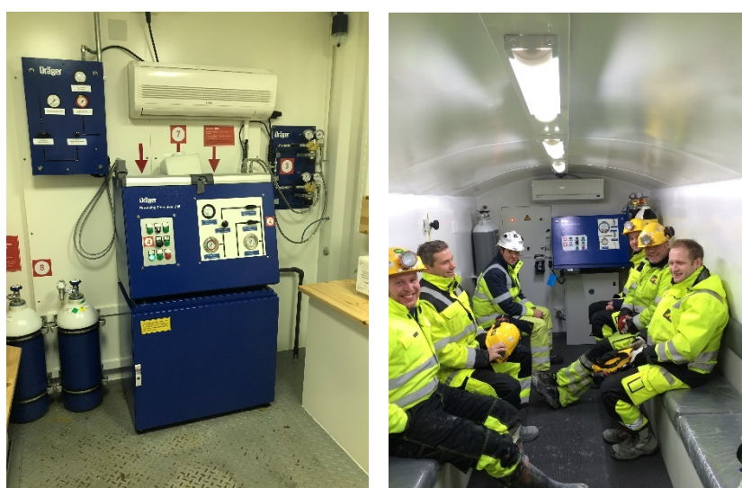
Figur 1. Styringspanel og oppholdsrom for profesjonelle i redningskontainer.
