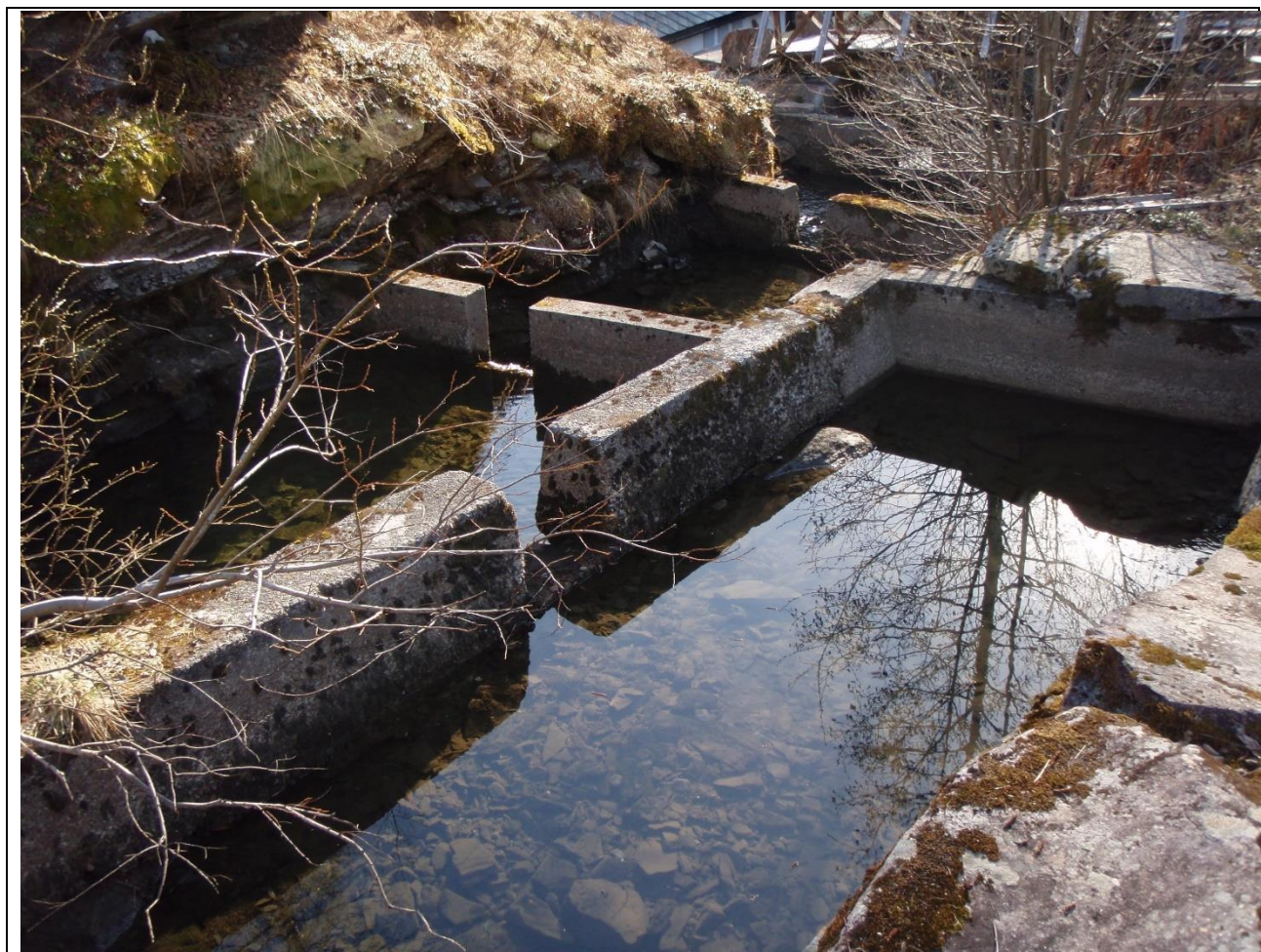
Figur 5. Fisketrappa i Hoelsfoss på baksiden av kraftverksbygningen, ovafor røret med produksjonsvann til kraftverket. Kulpene er grunne, slik at det blir for stor turbulens når vannføringa i trappa øker til normale driftsforhold.
