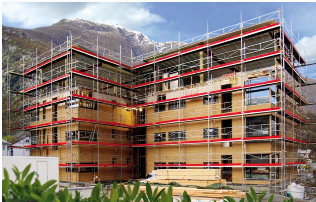
Ikke alle har fått med seg at stillaser må sertifiseres før de kan omsettes lovlig. Jamax stillassystem fra Alutec AS var imidlertid først ute med produktsertifikat. Illustrasjonsfoto: Alutec AS
