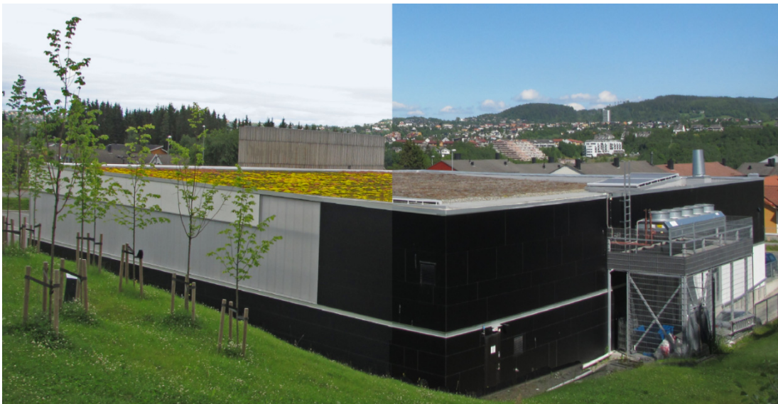
Figur 3: Sedumtak i Trondheim før og etter en litt for tøff vinter for taket. Høyre del av taket er fotografert ett år etter den venstre delen. Begge foto tatt i juli. (Thodesen et. al 2018)
