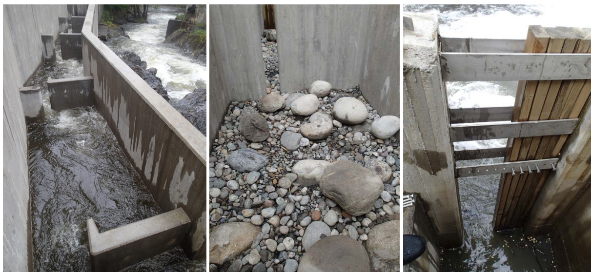
Figur 13 Norges første spaltetrapp i Akerselva Oslo med typisk diagonalt strømningsmønster, gjennomgående bunnsstrat og nålestengsel ved inntaket til finregulering av vannføring (Foto: Ulrich Pulg).
