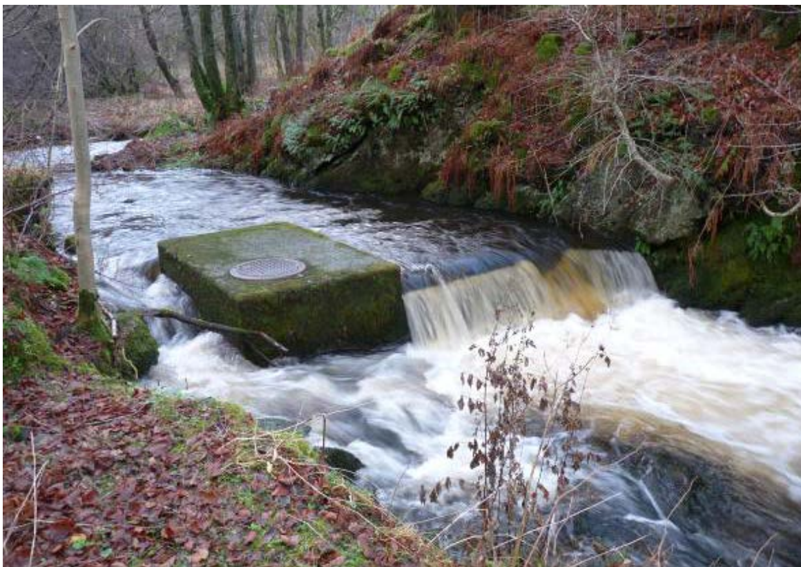
Figur 12 Eksempel på et lite omløp ved terskel med vanninntak i Apeltunelva, Bergen. Sideløpet til venstre for vanninntaket ble åpnet og sikret med stein. Fisk kan nå vandre fritt ved de fleste vannføringer. Tidligere kunne fisk bare passere ved større flommer (vannføringsavhengig vandringshinder). Sideløpet ble lagt slik at vanninntaket fortsatt fungerer etter hensikten (bidrag til sirkulering av brakkvannspoll), Bilder: Ulrich Pulg.
