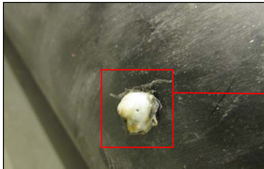
Fig. 51: Forboret hull i PP-rør – sett fra utsiden
