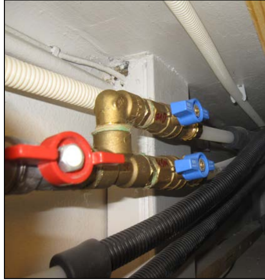
Fig. 80: Tilgang til stoppekraner bak luke i trappeoppgang
