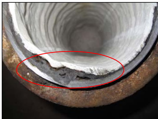
Fig. 59: Eksempel på rester av fett og avleiring grunnet mangelfull rengjøring før påføring av nytt belegg. Prøvestykket viste også tegn på korrosjon på baksida av relining. Kontroll utført i 2013
