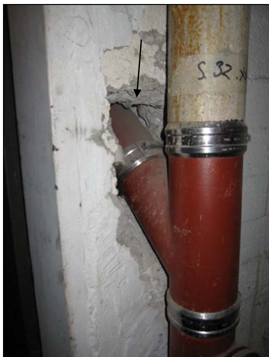
Fig. 83: Manglende branntetning mellom to brannceller i kjeller
