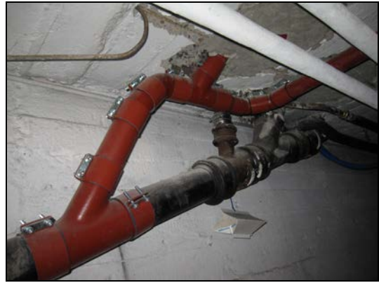
Fig. 82: Påkobling av nytt sluk i etterkant av rørføring. Opprinnelig støpejernsrør med svart utvendig belegg/maling har innvendig rørføring, mens nytt MA-rør med rødt utvendig belegg ikke har rørføring.
