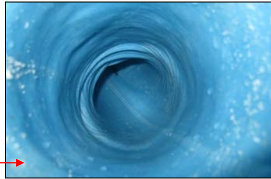
Fig. 54: Avløp til klosett sett ovenfra og ned i avløpsrør – kontroll utført i 2014 (anlegg ikke satt i drift ennå)
