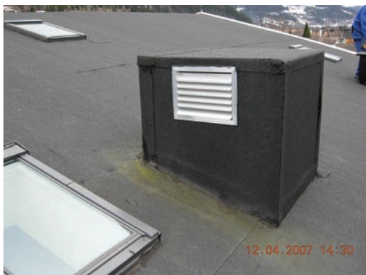
Fig. 5 a Et av friskluftinntakene (for to leiligheter) uten skjerming mot regn- og snøindrev. Foto: SINTEF Byggforsk
