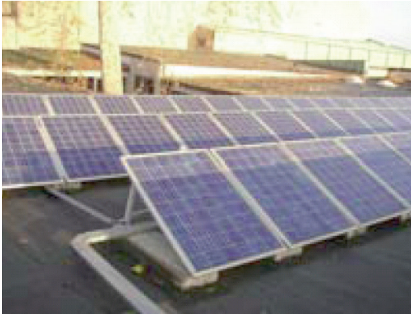
Fig. 8 c Solcellepaneler monterte på stativer på flate tak. Foto: Schonefeld [14]
