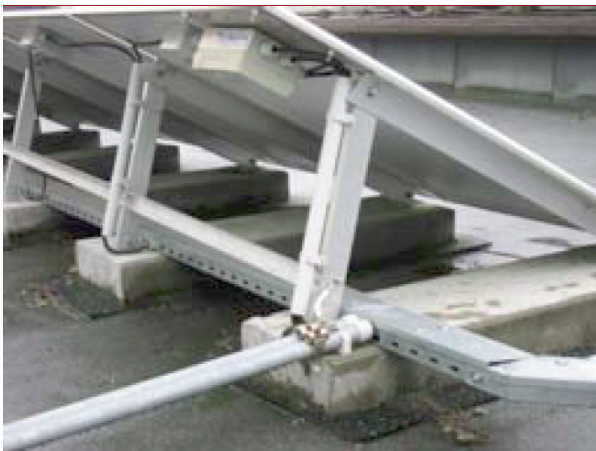
Fig. 8 d Nærbilde som viser eksempel på stativer festet på betongfundamentklosser lagt på et beskyttelsessjikt på taket. Foto: Schonefeld [14]
