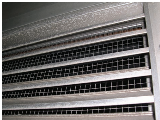
Fig. 4 c Opprinnelig hadde metallristen og blendingen vist i nærbilde her ingen ytterligere skjerming og var derfor ikke i stand til å stoppe snø- og regnindrev ved alle værforhold. Foto: SINTEF Byggforsk
