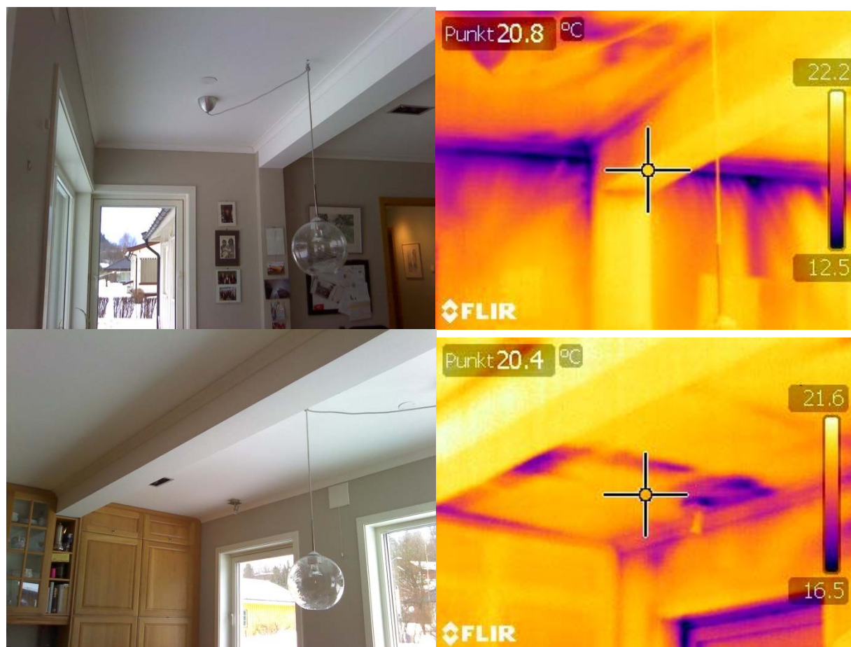
Figur 2 Lekkasjer og dårlig isolering i tilbygget (utvidet kjøkken).
