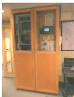
Figur 26 Skap med monitor, plassert på gang
