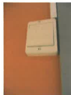
Figur 11 Bryter ved dør for å skru av og på døralarm
