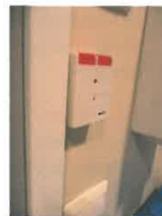
Figur 24 Eksempel på alarm på medisinrommet som ikke fungerer
