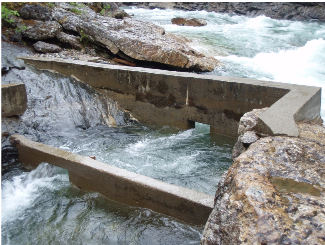
Figur 13. Øverste del av trapp 2 i Langfossen. Det er montert skinner for fisketeller i den andre betongveggen.
