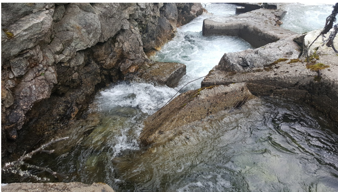
Figur 16. Skader på betong terskler i trapp 4 i Langfossen. (Foto Cato Haakseth)
