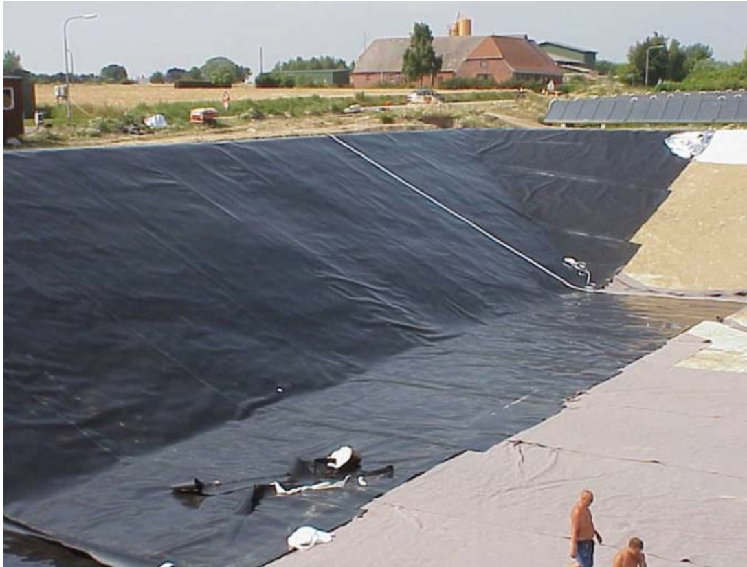
Figur 21: Gruslager ved Marstal Fjernvarme [20].
