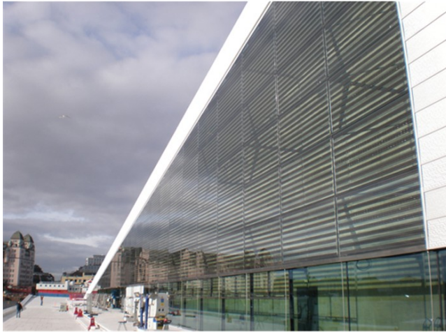
Figur 8: Solcellepanelet på Operaen i Bjørvika fungerer som solskjerming og leverer strøm til nettet [12].
