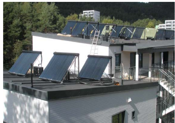
Figur 33: Bilde av solfangerne på Løvåshagen [6].
