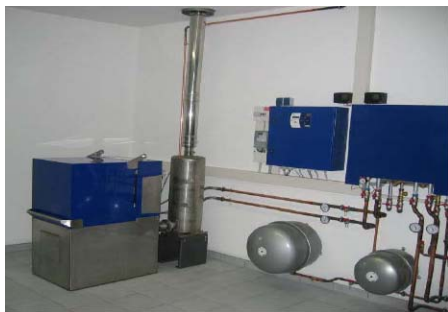
Fig 5.20 Micro CHP. Anlegget benytter biodiesel for å produsere elektrisk energi og varmt vann
