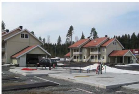
Fig 5.17 Fundamenter gjort ferdig, og huset er klar til å bygges. Teknisk infrastruktur er også lagt fram og kan etter hvert koples til installasjoner i huset. Elektriske kabler, fjernvarme, vann og avløp. Foto: SINTEF Byggforsk
