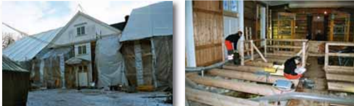
Fig. 51: Arkeologisk utgraving under Bygdøy kongsgård, utenfor Oslo, ved rehabilitering av hovedbygningen. Foto: Kulturhistorisk museum.
