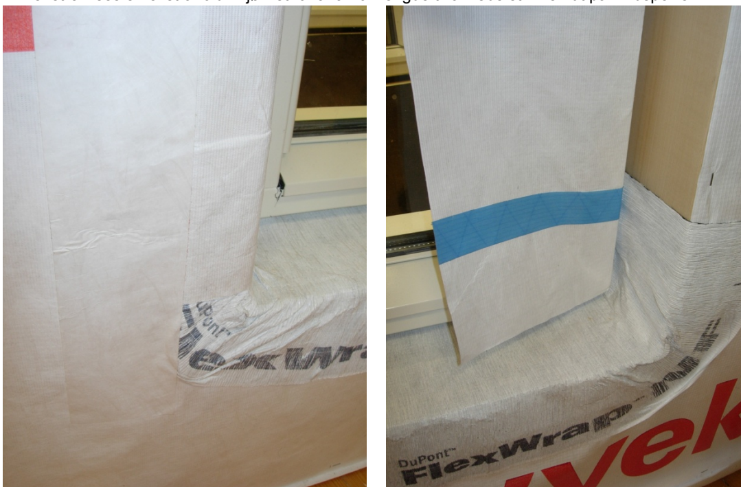
Figur 4.5.3. Vindspærrestrimler og vindspærre av polyetylenfibre som tetting rundt vindu. På den ene siden ble det brukt vindspærrestrimler med klebing (tosidig tape). På den andre siden ble vindspærrestrimlen festet til vindspærren med tape.
