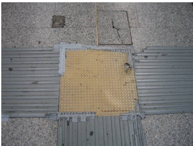
Fig. 54. Slitt gummibelegg som er limt på eksisterende gulv av naturstein kan føre til fall. Forsøk på reparasjoner gir i tillegg et sjabert inntrykk.
