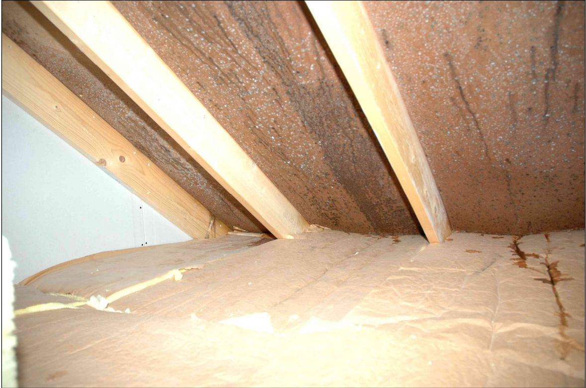
Figur 18 Rimdannelse på undertak i et kaldt, uluftet loftsrom
