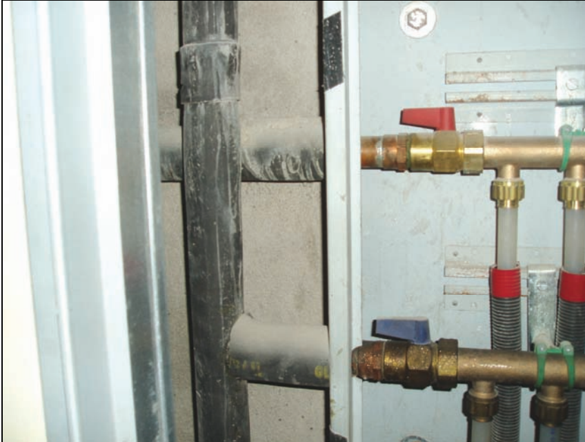
Figur 11: Stigerør av kobber ved siden av fordelerskap for rør-i-rør-system i veggen. Fordelerskapet mangler dør og sprutdeksel
