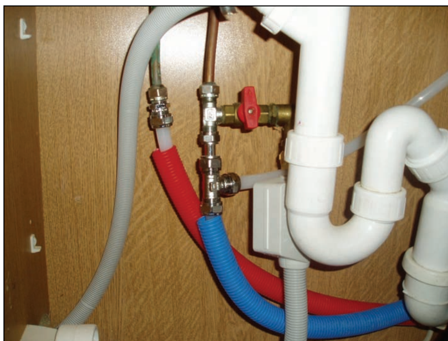
Figur 20: Rør-i-rør-avslutning i kjøkkenbenk, ingen tetning mellom vannrør og varerør
