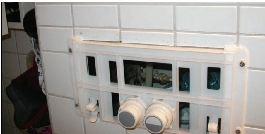
Figur 14: Avstegningsventil til leilighet er plassert bak deksel for trykknappen til vegghengt toalett.
