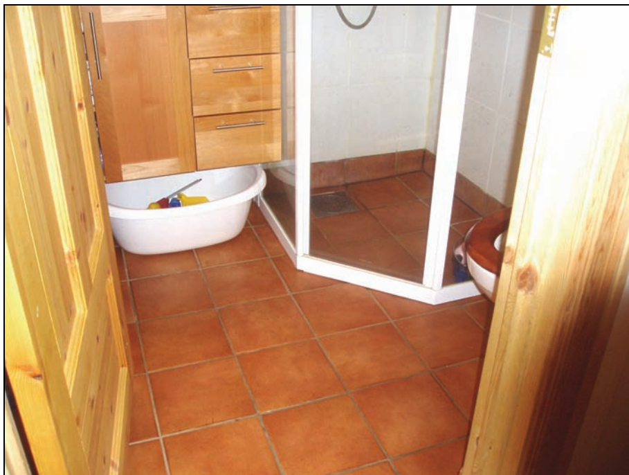
Figur 24: Sluket er montert inne i dusjhjørnet med tett sokkel mot golvet, som er høyere enn golvet ved døra.
