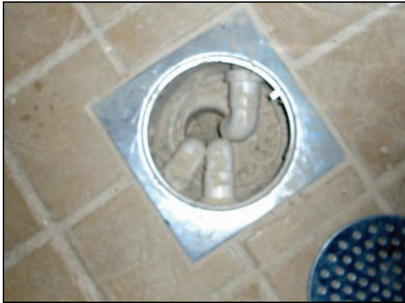
Figur 15: Bildet viser at påstøpen er lagt over vannlåsen. Dette hindrer at vannlåsen i sluket kan løftes ut av sluket for rensing.
