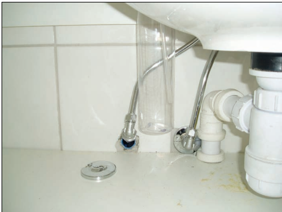
Figur 23: PEX-rør rett ut av vegg med direkte overgang til albue som er koblet til tilførselsrør av kobber som er koblet til tappearmaturen
