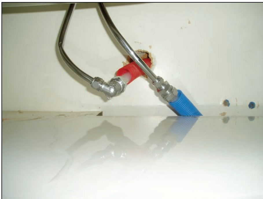
Figur 8: Ingen tetning mellom ytterrør og vannrør i kjøkkenbenk. Ytterrøret skulle ha laveste frie ende i badet, slik at lekkasjer oppdages der. I flere leiligheter ble det observert at laveste frie ende var i kjøkkenbenk. Ved lekkasje vil vannet renne ut i kjøkkenbenk.
