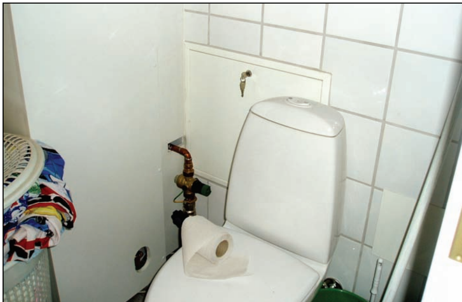
Figur 13: Fordelerskap for rør-i-rør er plassert utilgjengelig bak toalettet.
