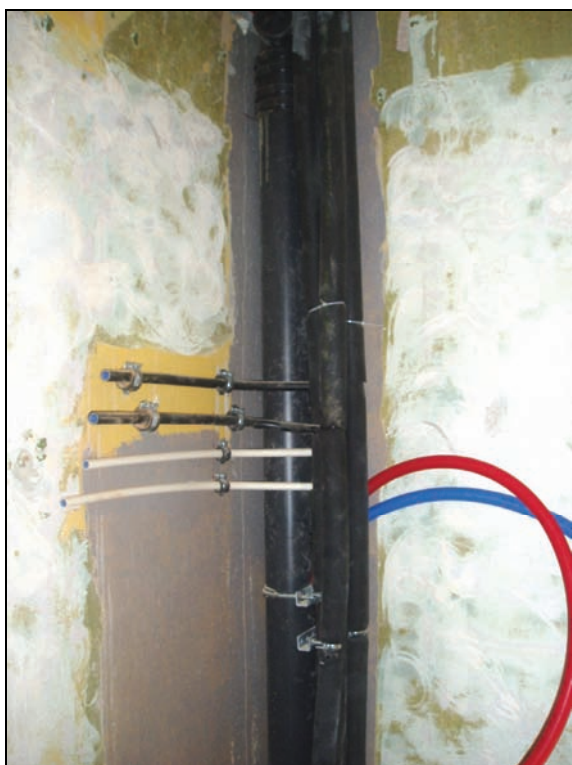
Figur 7: Vannopplegg med avstikkere (avstikker til hver leilighet). Varmtvannsforsyning fra felles sentral. Det ble ikke avklart på tilsynet om det var tatt tilstrekkelig hensyn til ekspansjon i røropplegget ved montering.
