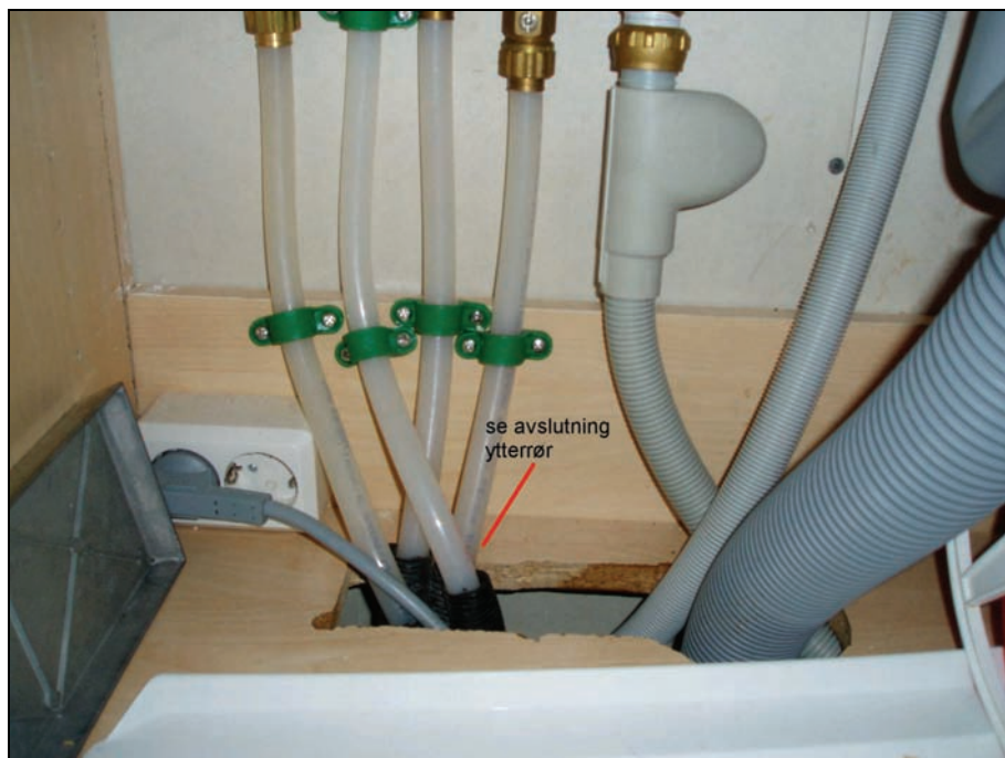
Figur 19: Mangler endetetning mellom varerør (ytterrør) og PEX-rør i kjøkkenbenk
