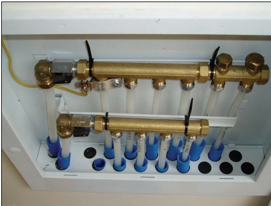
Figur 18: Fordelerskap uten drenering og varerør kappet i varierende høyde
