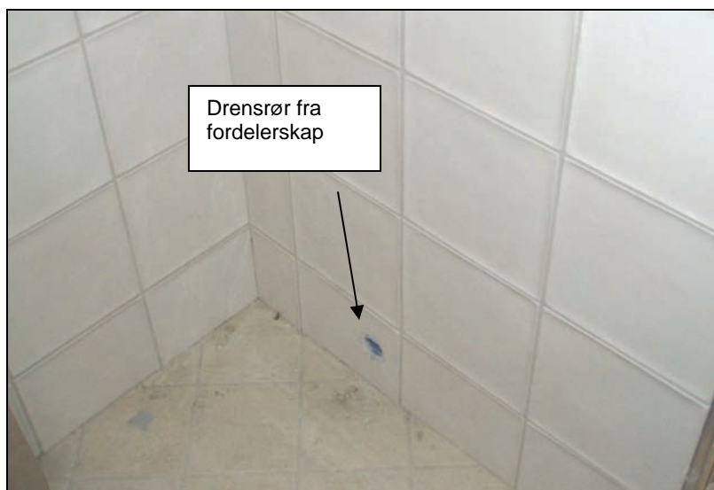
Figur 22: Drensrør fra fordelerskap ført til rom uten sluk
