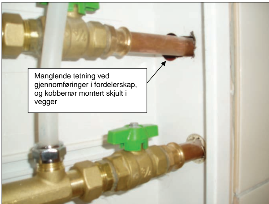
Figur 17: Manglende vanntetning ved gjennomføringer i fordelerskap
