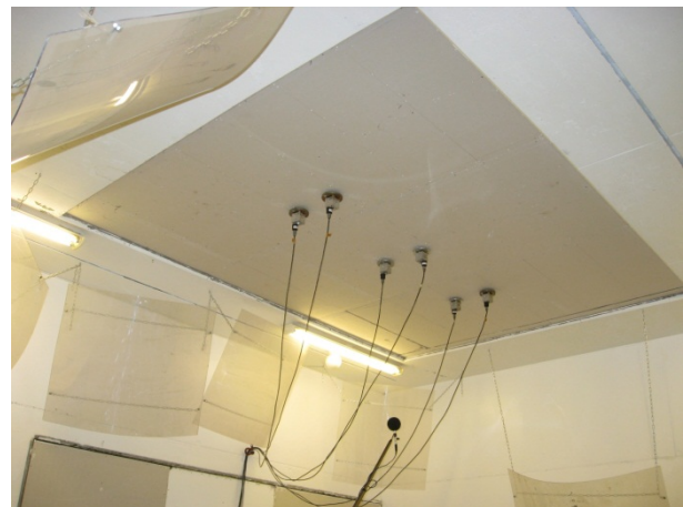
Foto av tak 3.5. NGI måleutstyr
