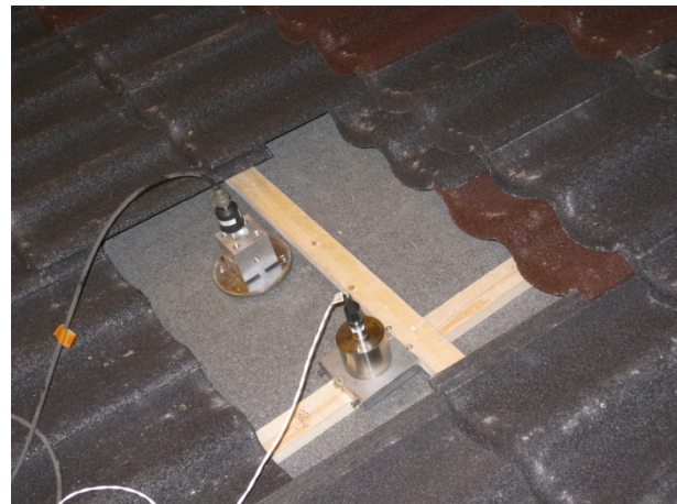
Foto av tak 3.5. NGI måleutstyr
