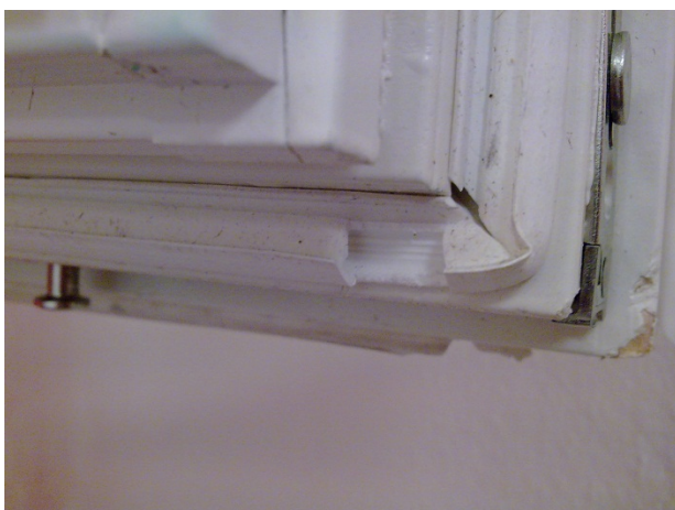
Foto 2.3.9. Vindu L1. 10 mm utsparring av tettelist i underkant av vindu (totalt 5 stk. oppe og nede)
