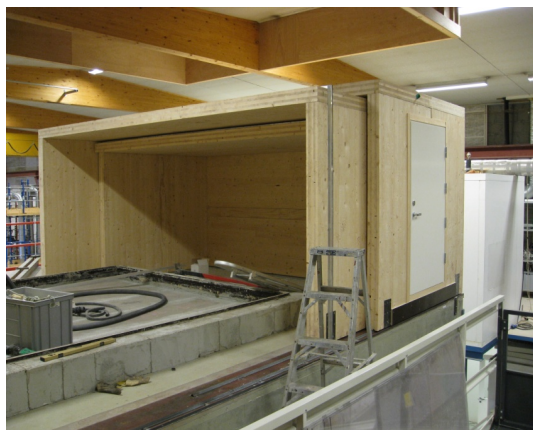
Foto A2. Prøveåpning for takmålinger og teleskophus (åpen stilling)
