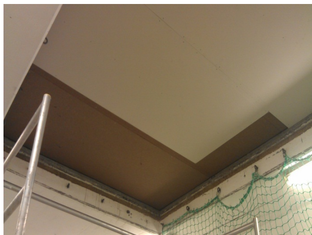
Foto av tak 4.2 og 4.4. Ekstra gipsplate
