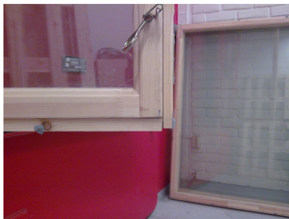
Foto 2.3.4. Påmonterte trelister i stedet for gummi-pakning
