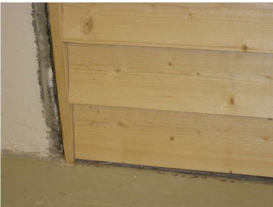
Foto av vegg 3.1. Utvendig kledning. Luftespalte!
