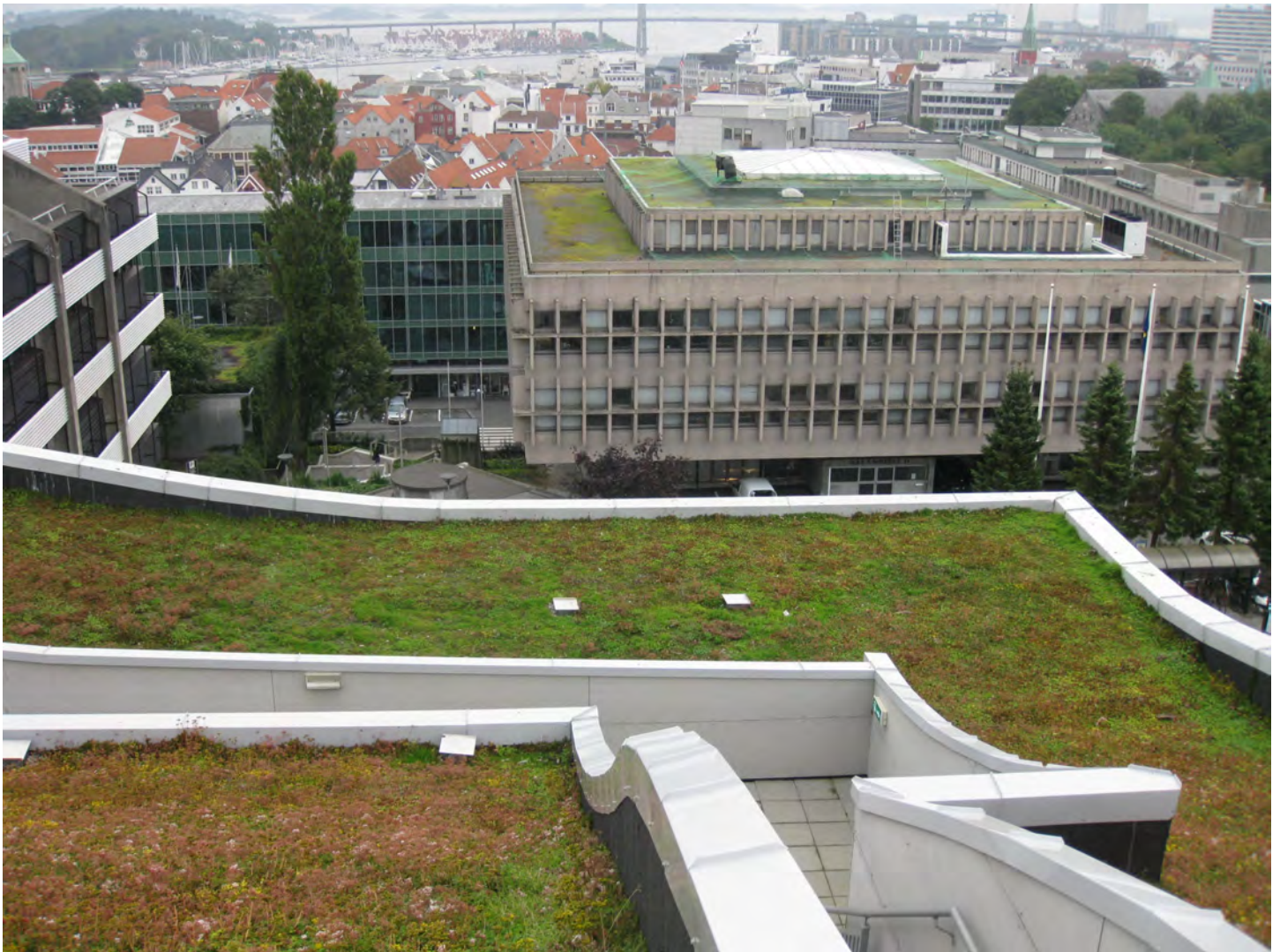
Gangarealer brukt som nødutganger. Foto: SINTEF Byggforsk
