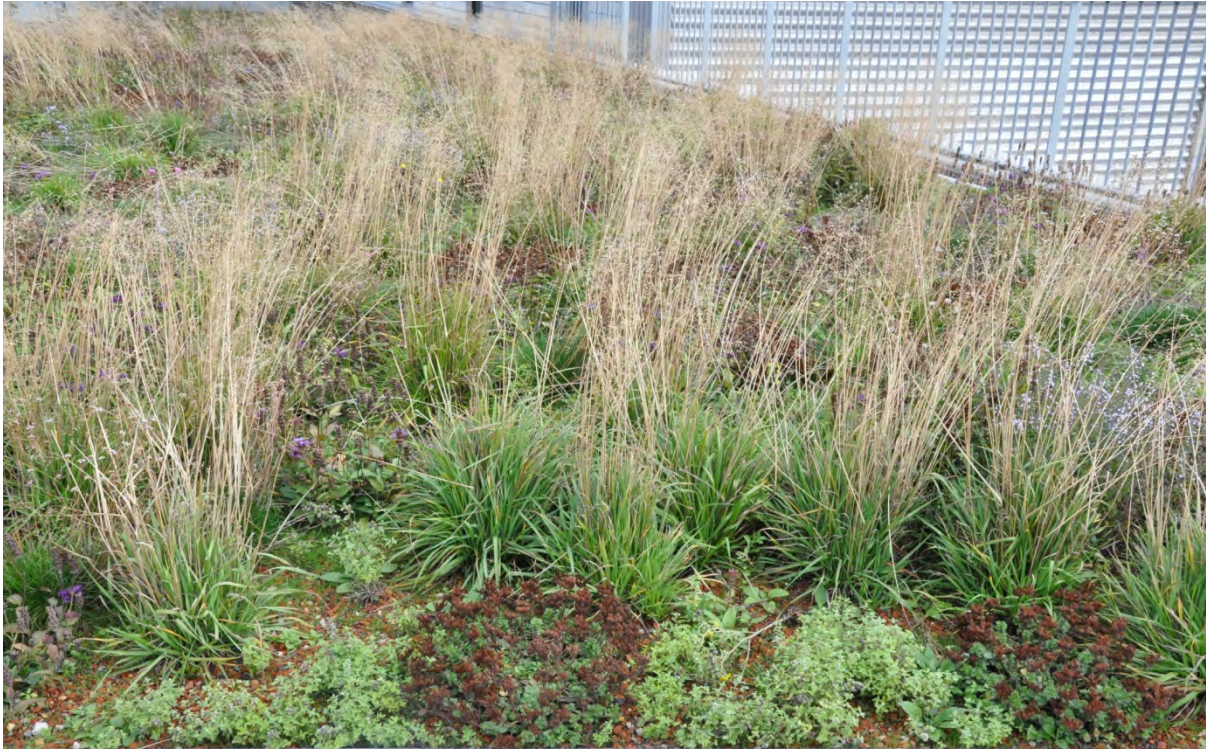
Fig. 5.8 Kombinasjon av flere gressarter og stauder, semi-intensivt tak på Riksarkivet i København. (Foto: ILP/UMB 2010)
