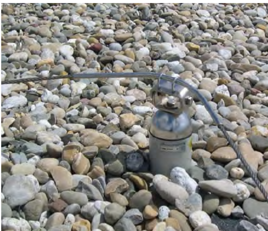
Figur 4.7. Eksempel på festepunkt for sikkerhetsline. Sikkerhetssele hektes på wiren med en spesiell låsemekanisme og som kan gli langs wiren. (Foto: SINTEF Byggforsk)
