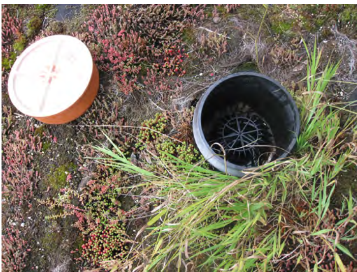
Sluk med inspeksjonsbrønn. Foto: SINTEF Byggforsk
