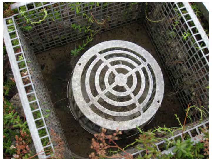
Sluk med inspeksjonsbrønn. Foto: SINTEF Byggforsk
