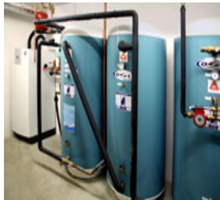
Fig A3.6 Akkumulatortanker i tilknytning til varmepumpa.
