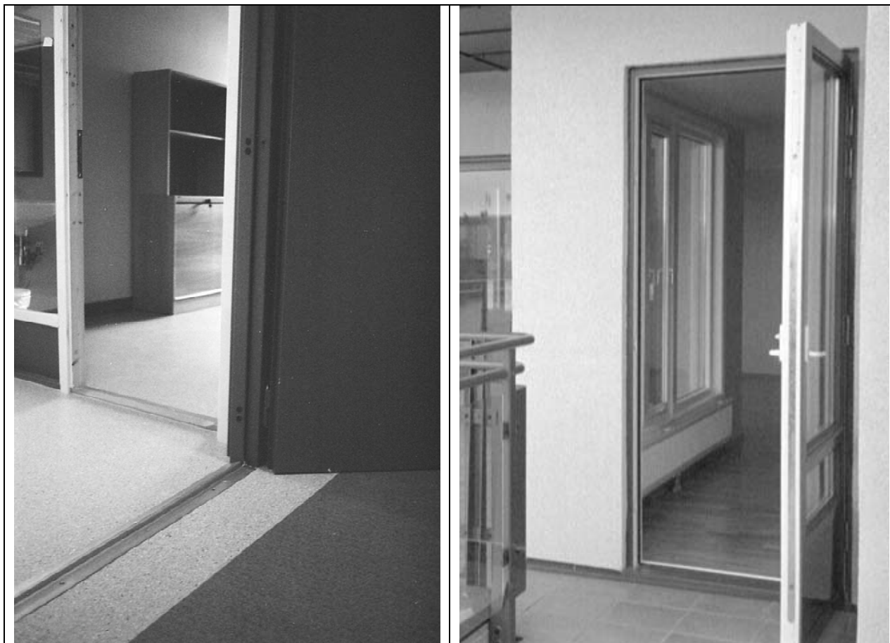
Til venstre: God løsning av et vanskelig detaljeringsproblem; overnag mellom en eksisterende bygning og et tilbygg, med brannkrav til døra mellom bygningene. Til høyre: terskel på terrassedør. Lav terskel og overgang uten nivåforskjell er et alminnelig problem.
