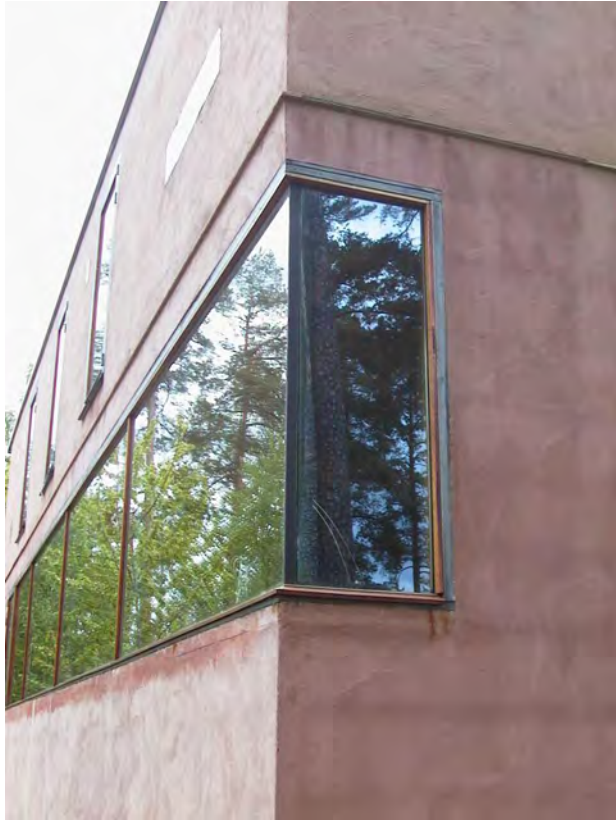
Foto 7 Vindu montert i plan med veggliv. Horisontal sprekk under langvinduet. (Foto: Geir Wold Hansen)
