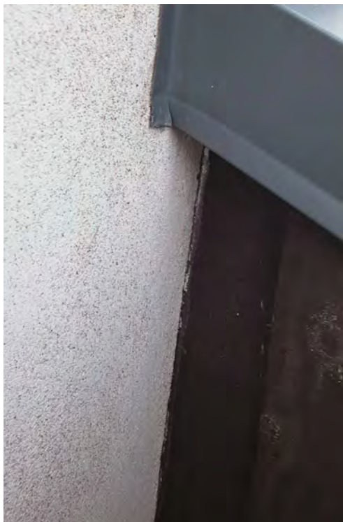
Foto 7 Murverk pussa mot trekledning (Foto: Geir Wold Hansen)
