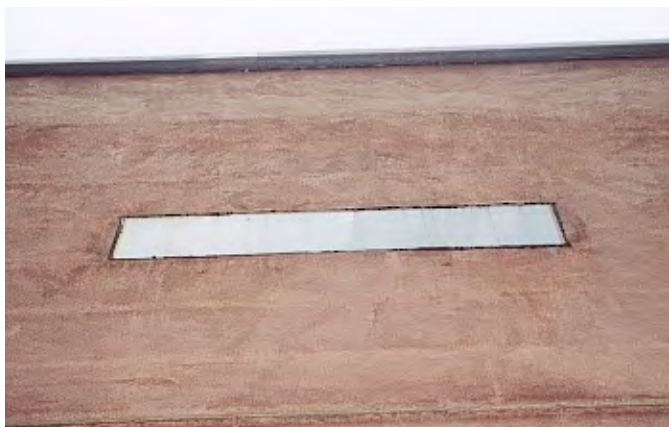
Foto 8 Vindu på hjørnesoverom er utan karm og festa med fugemasse (Foto: Alf M. Waldum)
