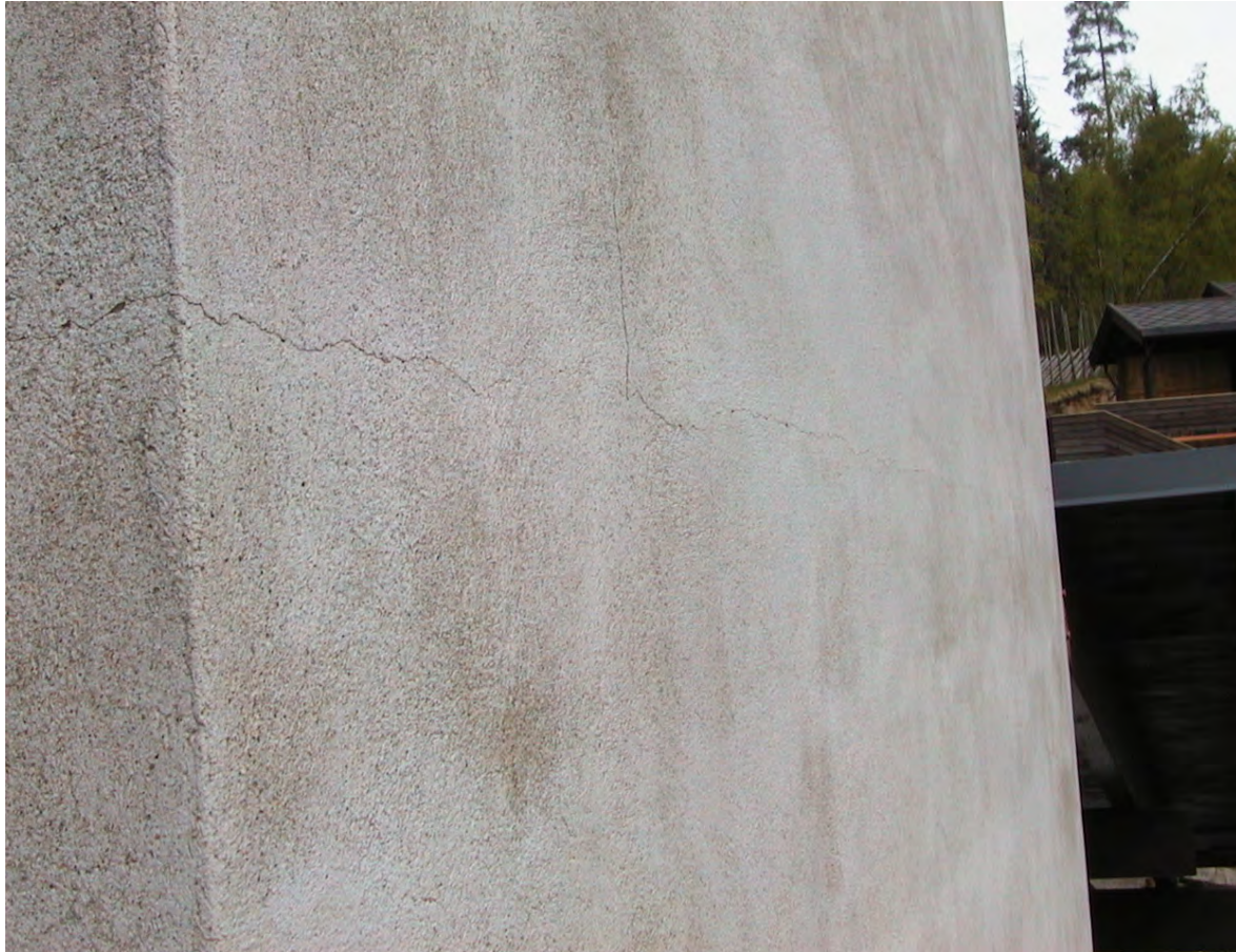
Foto 6 Horisontal sprekk i murverket (Foto: Geir Wold Hansen)
