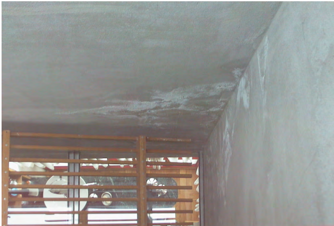
Foto 3 Fuktinntrenging gjennom yttervegg på soverom. Foto tatt frå overlysvindu (Foto: Geir Wold Hansen)
