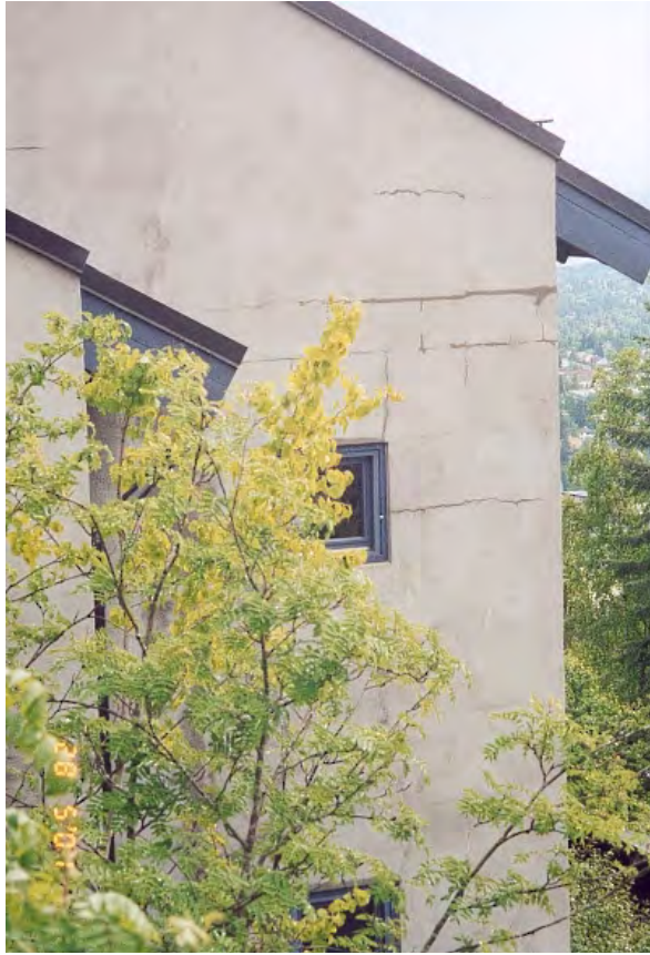
Foto 5 Riss i nordfasade (Foto: Alf M. Waldum)
