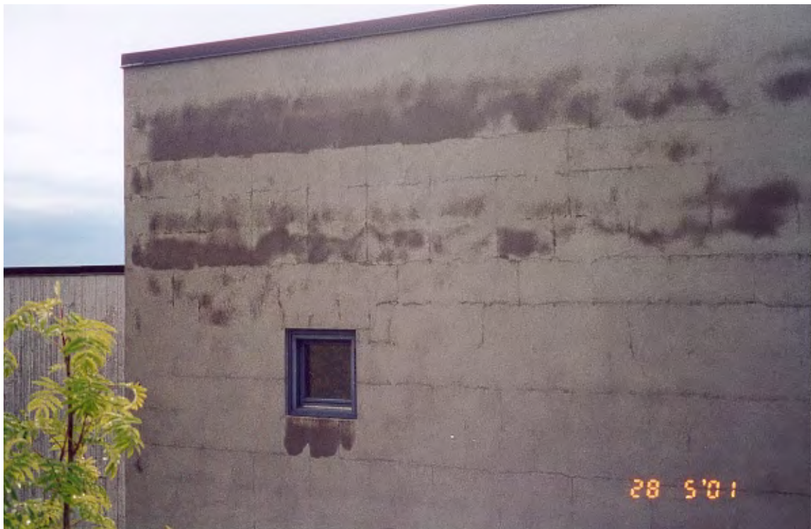
Foto 4: Austfasade med mange riss (Foto: Alf M. Waldum)
