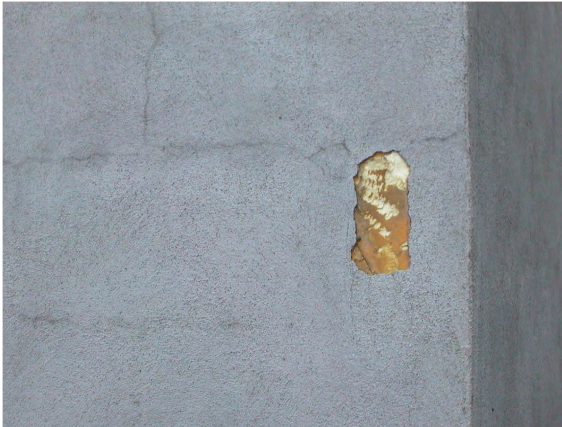
Foto 8 Puss over varmeisolasjonskjerna har lausna. Riss i pussen (Foto: Geir Wold Hansen)
