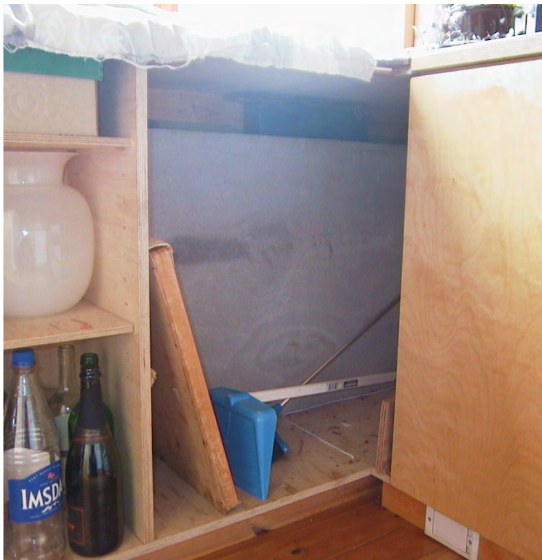
Foto 4 Fuktinntrenging gjennom yttervegg ved oppvaskbenk (Foto: Geir Wold Hansen)
