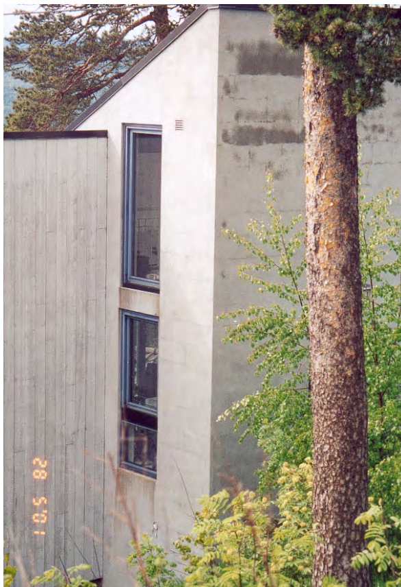
Foto 7 Fasade mot sør og aust har mange riss (Foto: Alf M. Waldum)
