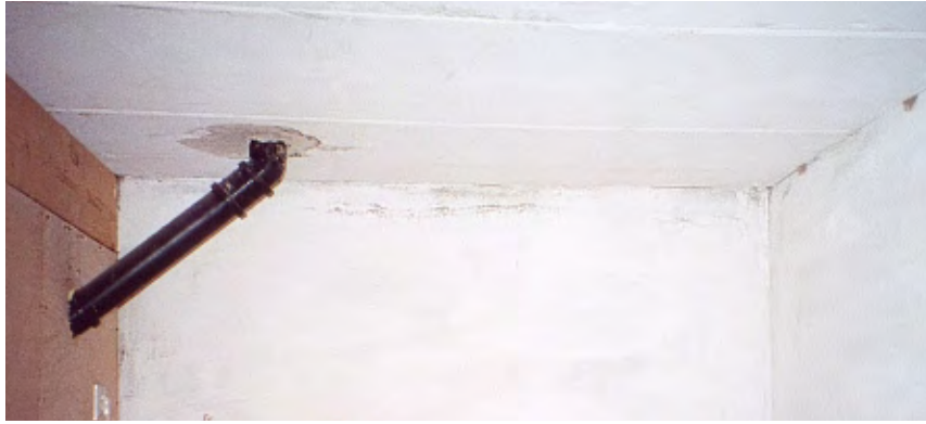
Foto 5 Fuktinntrenging underkant etasjeskiller i bod (Foto: Tore Kvande)
