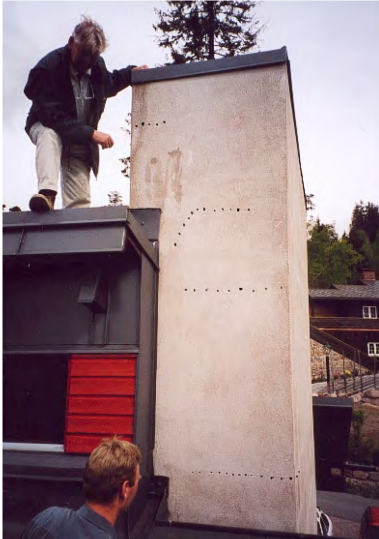
Foto 5 Sørvendte delen av murt karnapp. Synlege riss ved studie av foto med lupe er markert med tusj. (Foto: Tore Kvande)
