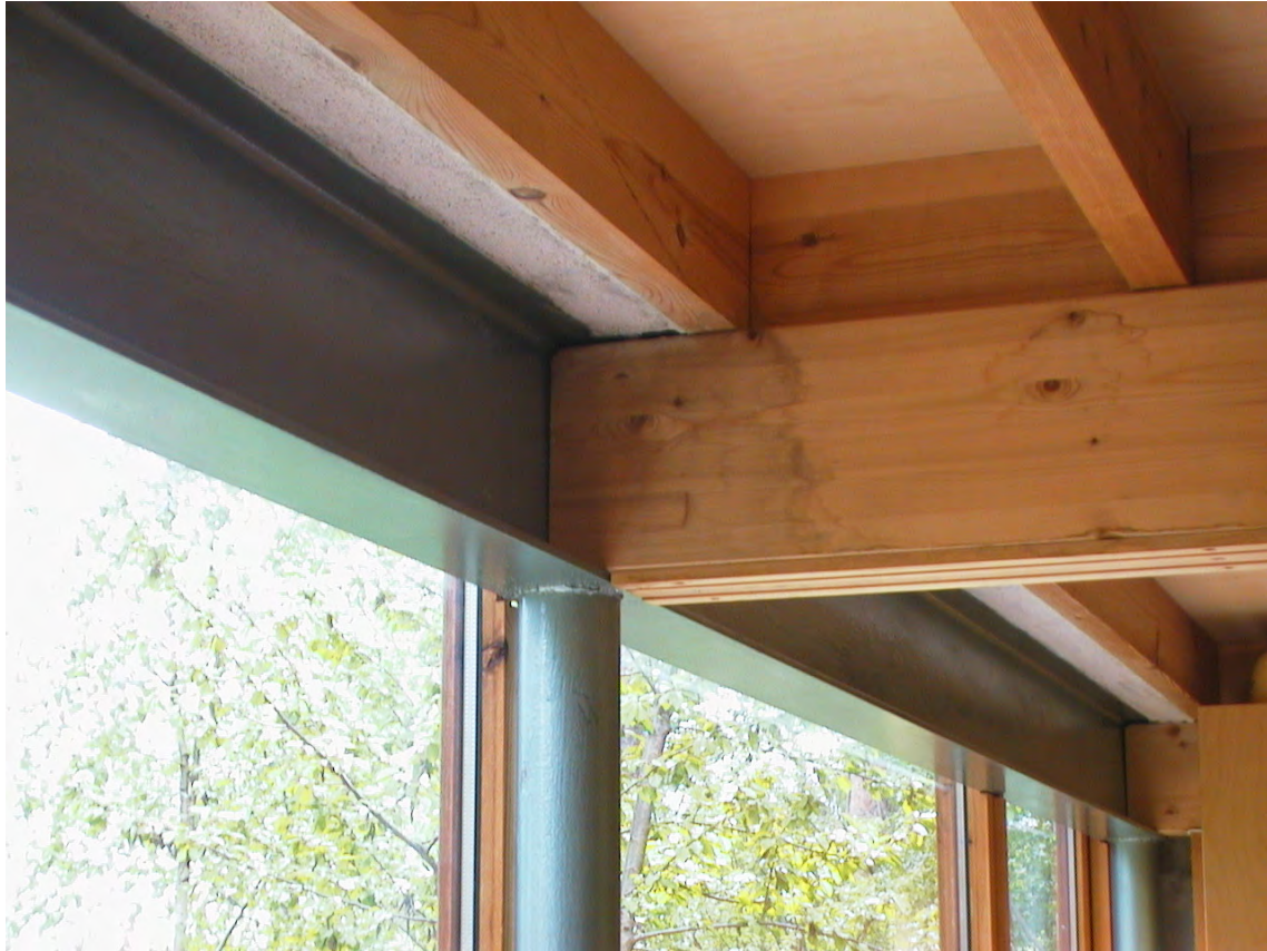
Foto 3 Fuktinntrenging over langvindu mot søraust (Foto: Geir Wold Hansen)
