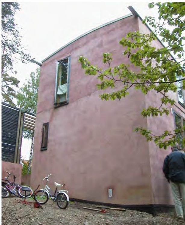
Foto 6 Farge- og strukturforskjellar på fasade mot sørvest (Foto: Geir Wold Hansen)
