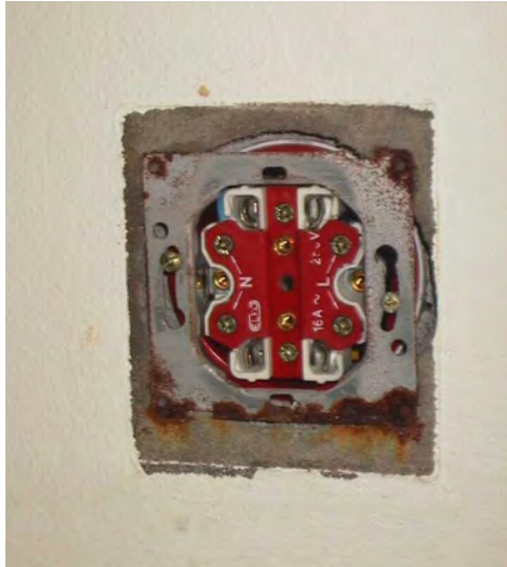
Foto 3: Elektrisk kontakt på kjøkkenet har korrosjonsskadar (Foto: Geir Wold Hansen)
