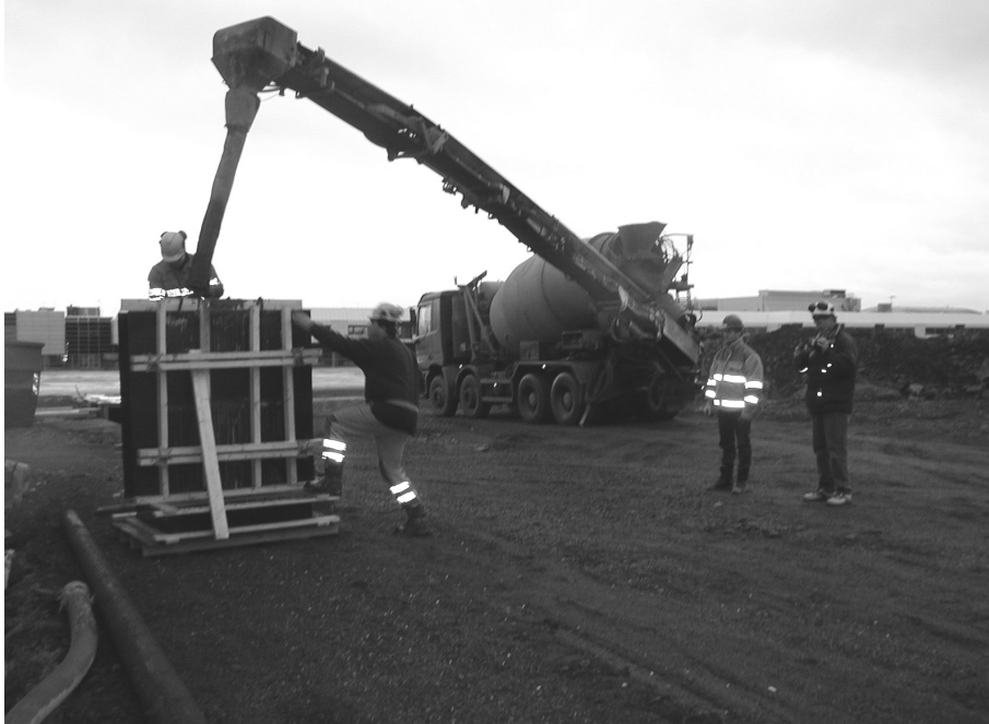
Figur 9. Prøvestøp med NA-betong med resirkulert tilslag forut for utstøping av fundamenter til P-hus, Fornebu.
