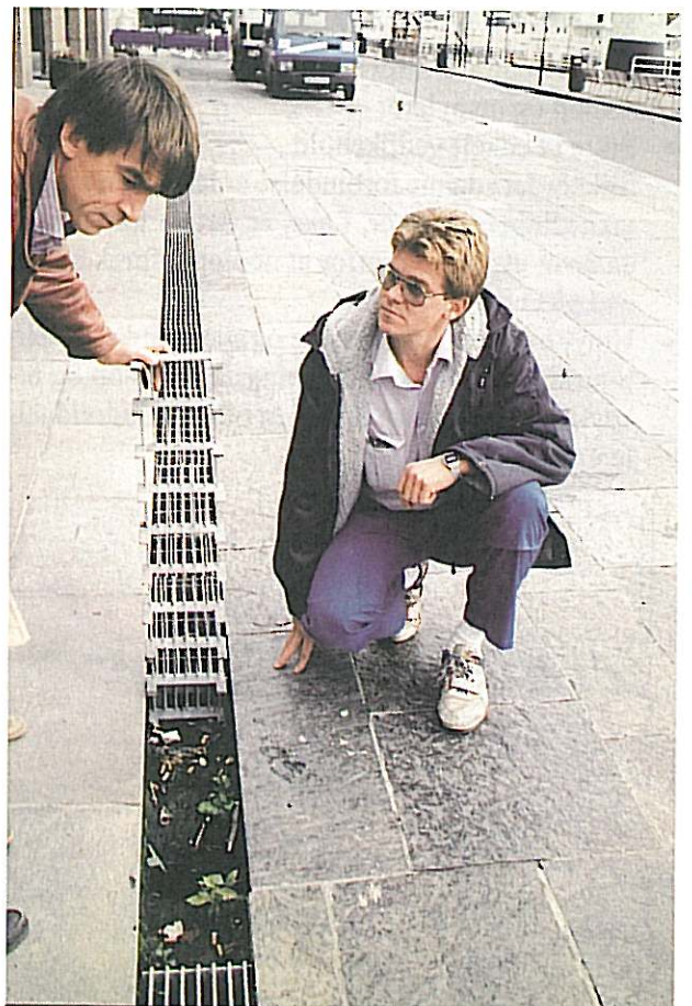
Åpne renner av denne typen gir økt vedlikehold. Rennene må rengjøres i en egen operasjon.
