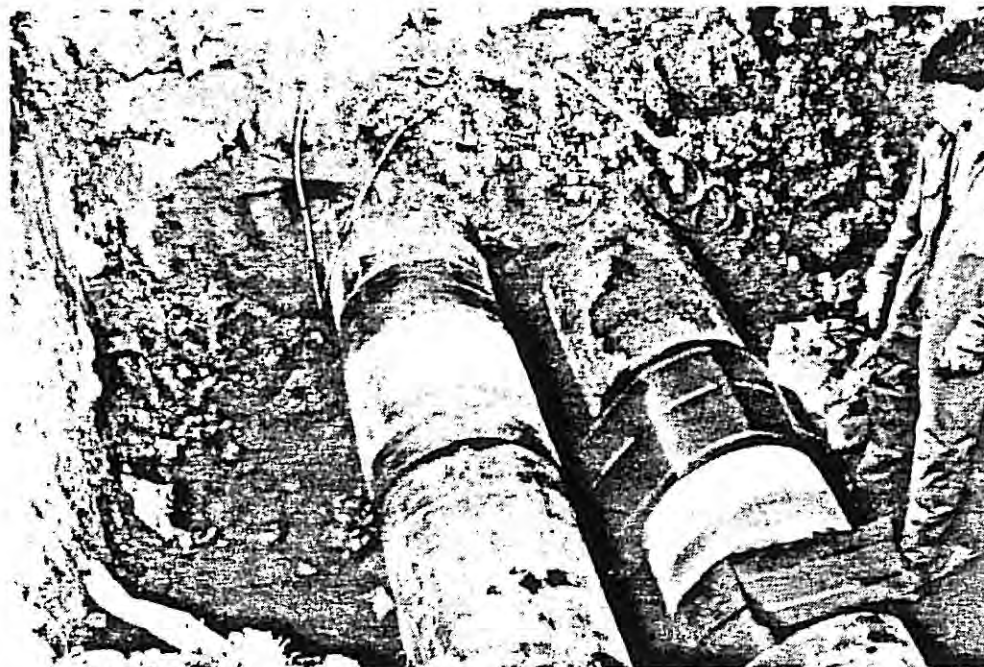
Fig. 47. Skader på krympefolien på preisolerte fjernvarmerør vil hurtig ødelegge polyuretanens isolasjonsevne, og vil føre til korrosjon på stålrøret.
