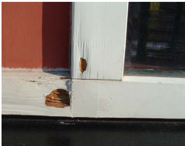
Figur 7.3 a Endevæde som er dårlig forseglet og suger til seg vann kapillært.
