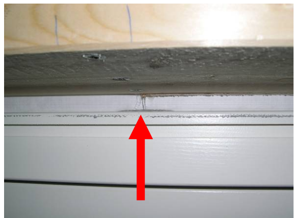
Figur 3.7.4. Vann renner via plateskjøt og inn mellom vindsperreremse og plate over vindu
