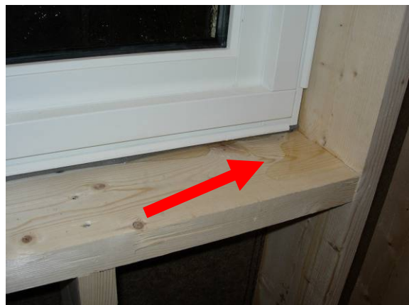
Figur 3.3.4. Vannlekkasje i underkant vindu
