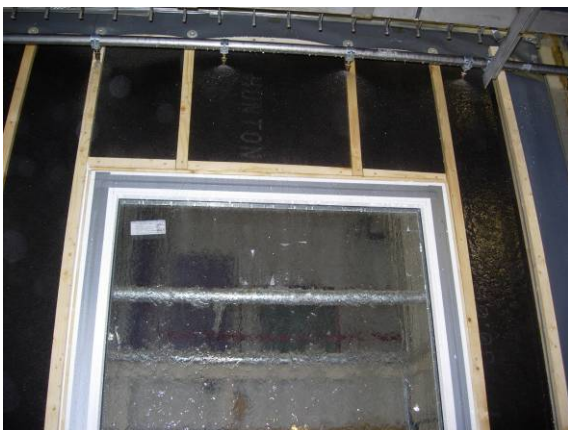
Figur 3.3.3. Prøvefeltet under slagregnsprøvingen
