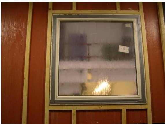
Figur 3.8.1. Prøvefeltet under slagregnsprøvingen
