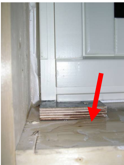
Figur 3.5.3. Vannlekkasjer ved hjørne og i underkant vindu
