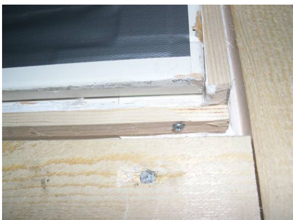
Figur 3.10.3. Utfresing av spor for vannbrettbeslag gir liten plass for lekt underkant vinduskarm
