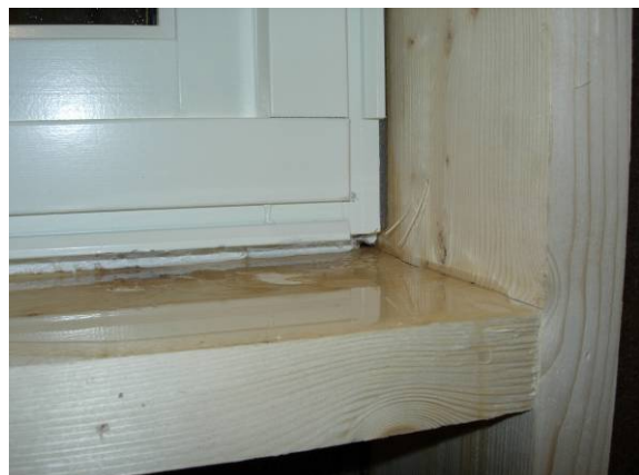
Figur 3.4.4. Når bunnfyllingslisten ble fjernet kunne en se at fugemassen ikke hadde fylt ut i hele fugen
