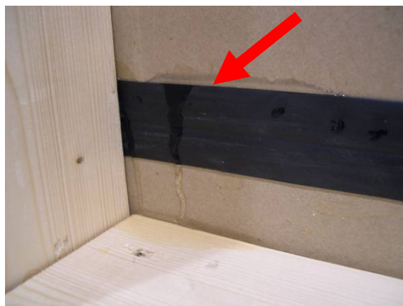
Figur 3.8.4. Vann trenger inn i horisontal plateskjøt med skjøtelist av plast
