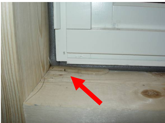
Figur 3.4.3. Bunnfyllingslist sett innenfra, lekkasje i underkant vindu
