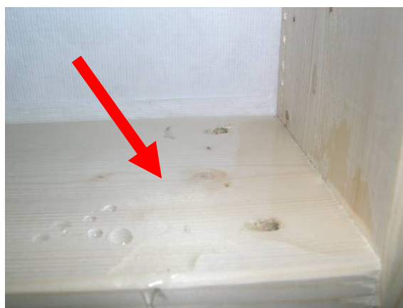
Figur 3.11.4. Vanninntregning ved tape i vindushjørne renner ned på losholt ved horisontalskjøl
