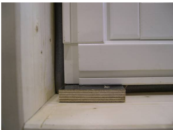
Figur 3.8.3. Anlegg for vindu og justeringshylser gjør det vanskelig å fuge mellom stender og vinduskarm
