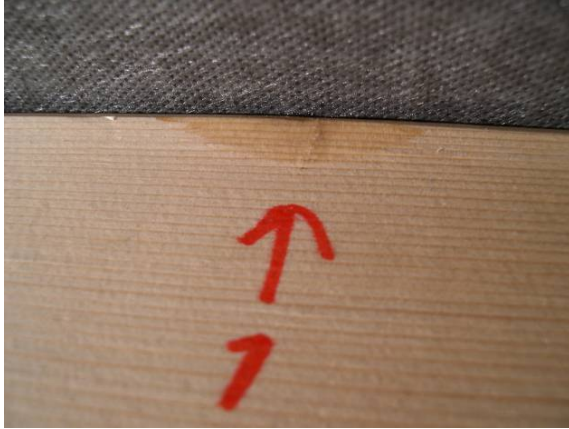
Figur 26 Lekkasje nr. 1 under første runde med nedsilende vann
