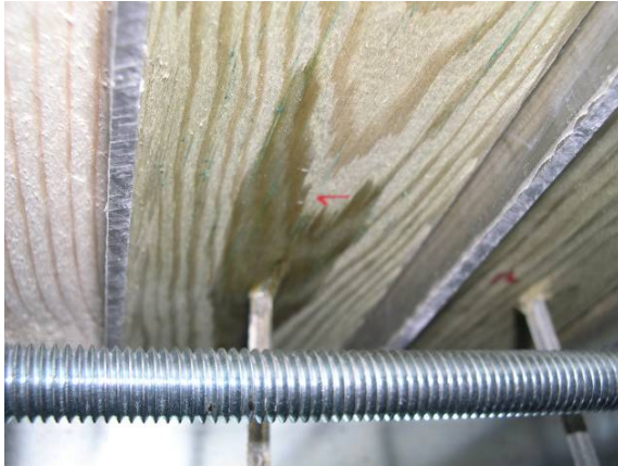
Figur 14 Fuktflakk ved håndspiker i trykkimpregnert materiale
