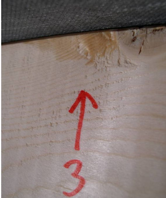
Figur 28 Lekkasje nr. 3 under første runde med nedsilende vann
