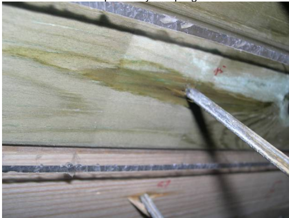
Figur 16 Fuktflakk ved håndspiker i trykkimpregnert materiale
