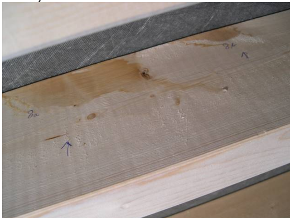
Figur 30 Lekkasje nr. 8a og 8b under kjøring med nedsilende vann og pulserende lufttrykk
