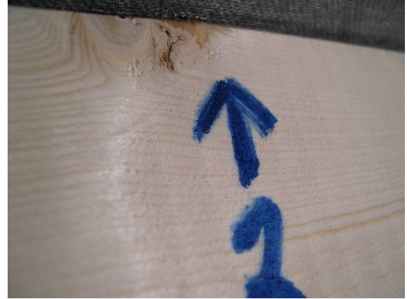
Figur 27 Lekkasje nr. 2 under første runde med nedsilende vann
