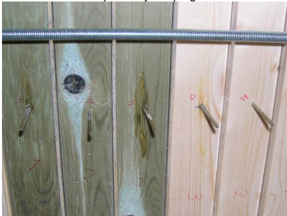
Figur 18 Fuktflakker i trykkimpregnert og ubehandlet trevirke
