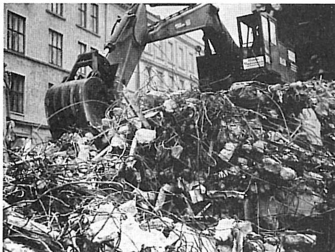
Figur 9. Opplasting av knuste bygningsmasser med grave-maskin. ■ Charging crushed material by the use of excavators.
