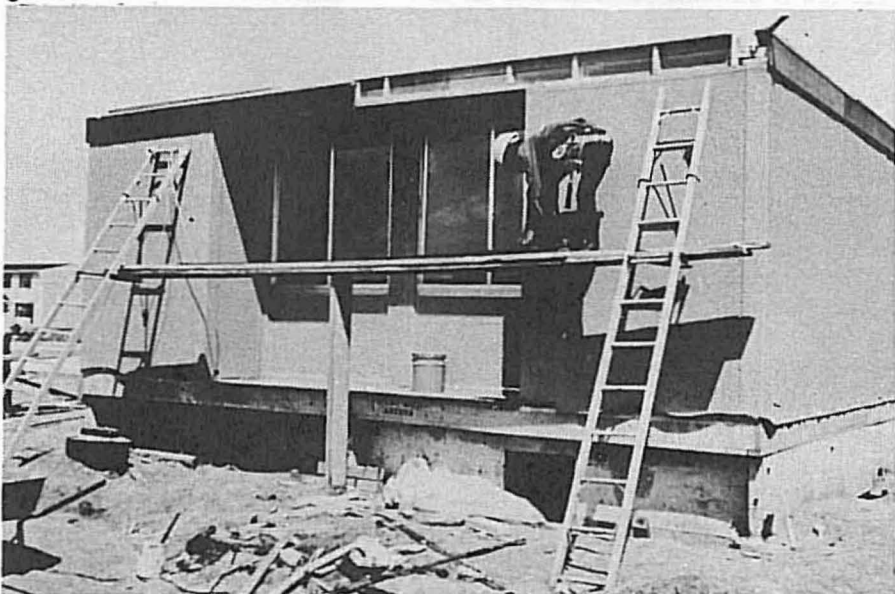
Fig. 4. Byggesystem Hercules, Variasjon i utseende skapes ved utvendig "pynt" og veksling mellom kryssfinér og aluminium kledning.
