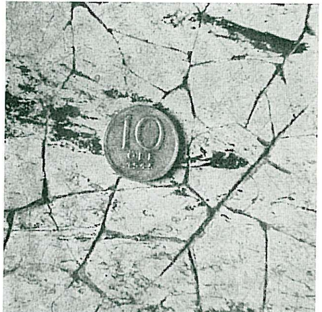
Fig. 15. Sprøe vinylfliser på tregulv med harde trefiberplater. Her har deformasjonene i gulvet vært så store at flisene har sprukket [3].
