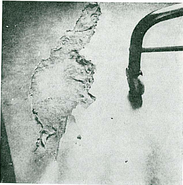
Fig. 13. Linoleum på et dårlig sparkelunderlag. Sparkelmassen har ikke hatt tilstrekkelig trykkfasthet og er knust under rullene på kontorstolen. Linoleumen løsnet og ble utmattet i løpet av noen få dager så det oppstod buler. Derefter gikk det hull på linoleumen efter ca. én måned [3].
