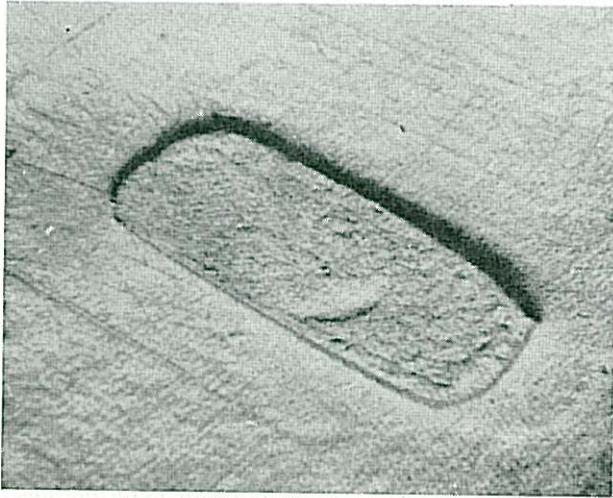
Fig. 12. Typisk eksempel på at belegg og undergulv ikke har tålt belastningen fra en bokhyllé [3].
