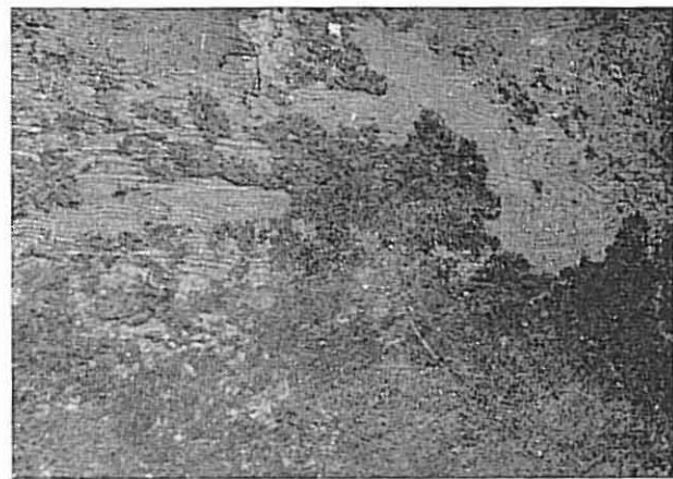
Fig. 5. Betongoverflate ved første (øverst) og annen gangs bruk av samme forskaling. (Foto: M. M. Adam, Paris.)
