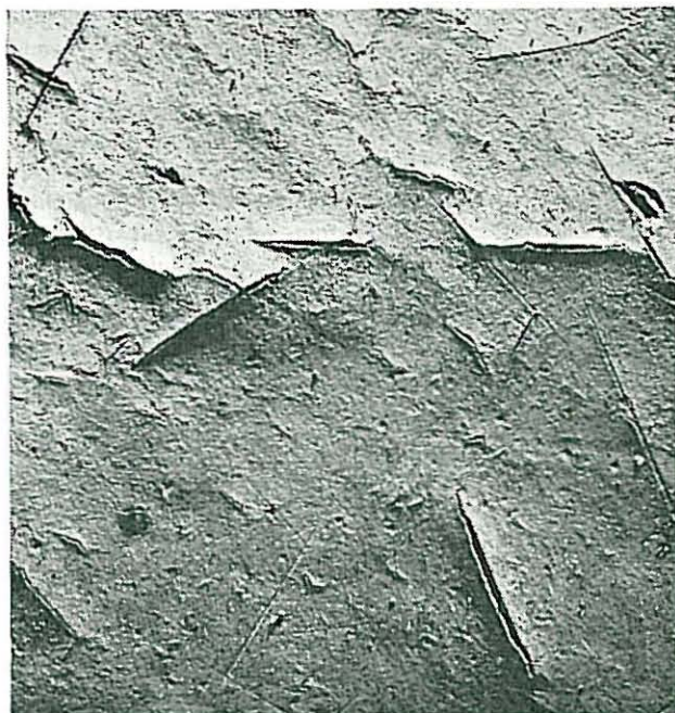
Fig. 4. Sterke alkalier i rengjøringsmidlet har tørret istykker gulvbelegget. Ved stell av gulv bør man følge fabrikantenes bruksanvisninger.
