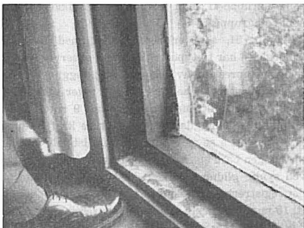
Fig. 6. Eksempel på kittskade på grunn av feil innsetting og for dårlig kitt.
