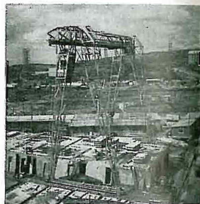
Fig. 2b. Pelare och mittbalk monteras av strängbetongelement och bjälklagen av färdiga betongelement (AH-element).
