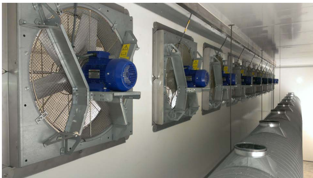
Figur 2: Sirkulasjonsvifter i kammer, med kanal for tilførsel av tørkeluft fra aggregat.
