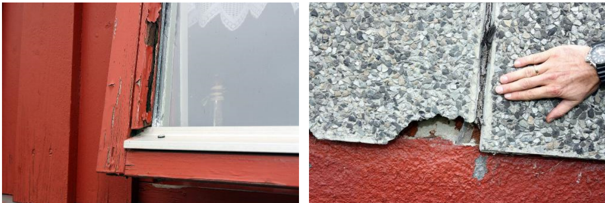
Sprekker i gavlvegg og råte i vinduskarm. (Foto: Romerikes Blad)
