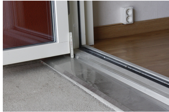
Selv om universell utforming ikke har vært i fokus på Backa Röd, har terskelen ut til balkong en tilfredsstillende løsning. (Kilde: SINTEF Byggforsk)
