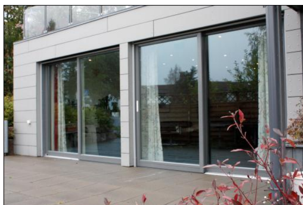
Skyvedører med lav terskel til terrasse. Det er ikke meldt om fuktskader, selv uten overdekking av dørene.
