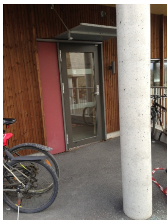
Eksempel på hindringer ved inngangsdør. Søyle og sykkelparkering skaper hindringer, og det hjelper lite om terskelen er lavere enn 25 mm.
