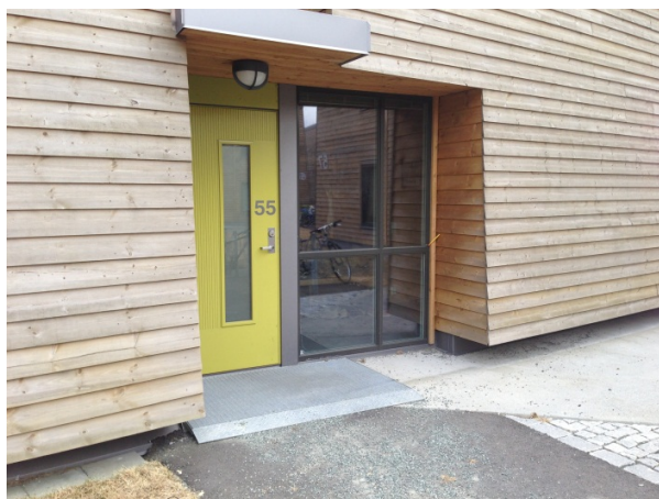
Løsning på terrasse. Prinsippet kan fungere, men det er for små dimensjoner på det horisontale feltet til å ivareta snuareal på minst 1,5 m x 1,5 m utenfor dørens slagradius (TEK10).
