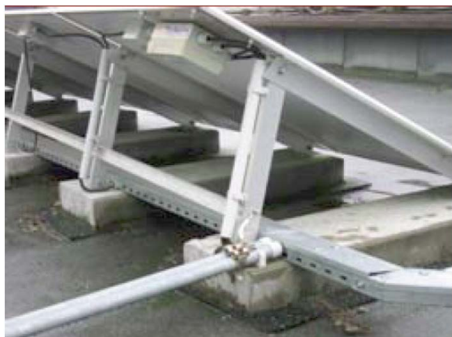
Figur 41 Stativ festet på betongfundamentklosser lagt på et beskyttelsessjikt på taket. Klossene fungerer som ballast. Foto: Schonefeld. Kilde: Flate tak (2008).
