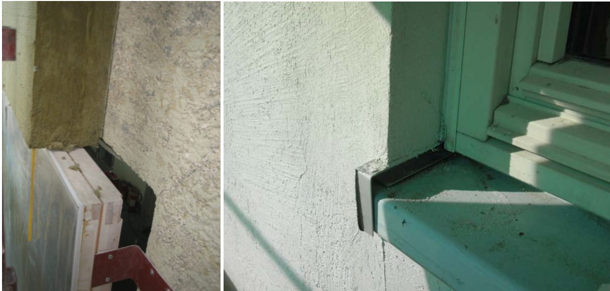
Figur 21 Vindusinnsetting på Sinsen skole under arbeid og etter ferdigstilling. Bildet til venstre viser innfesting med stålvinkler og vinduets nye plassering i isolasjonssjiktet. Bildet til høyre viser endelig fasadeoverflate med puss mot U-list limt på vinduskarm og ned mot sålbenkbeslag. Foto: Multiconsult.
