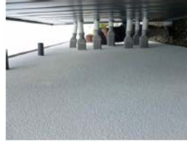
Under: tilslutning til aggregatet i container
