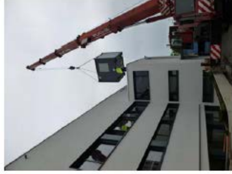
Over: container med aggregat
