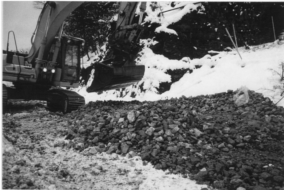
Figur 6. Utlekking av resirkulert tilslag 38-120 mm (blandet masse) som forsterkningslag på G/S-veg E18 Skøyen
